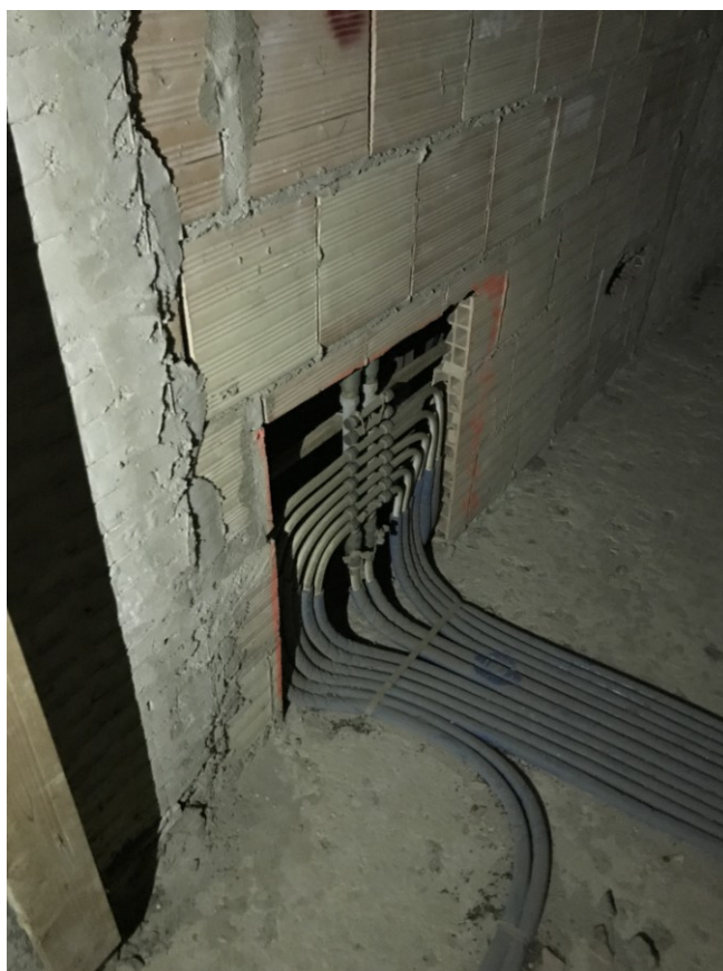
Foto n. 14: particolare collettore impianto di riscaldamento
