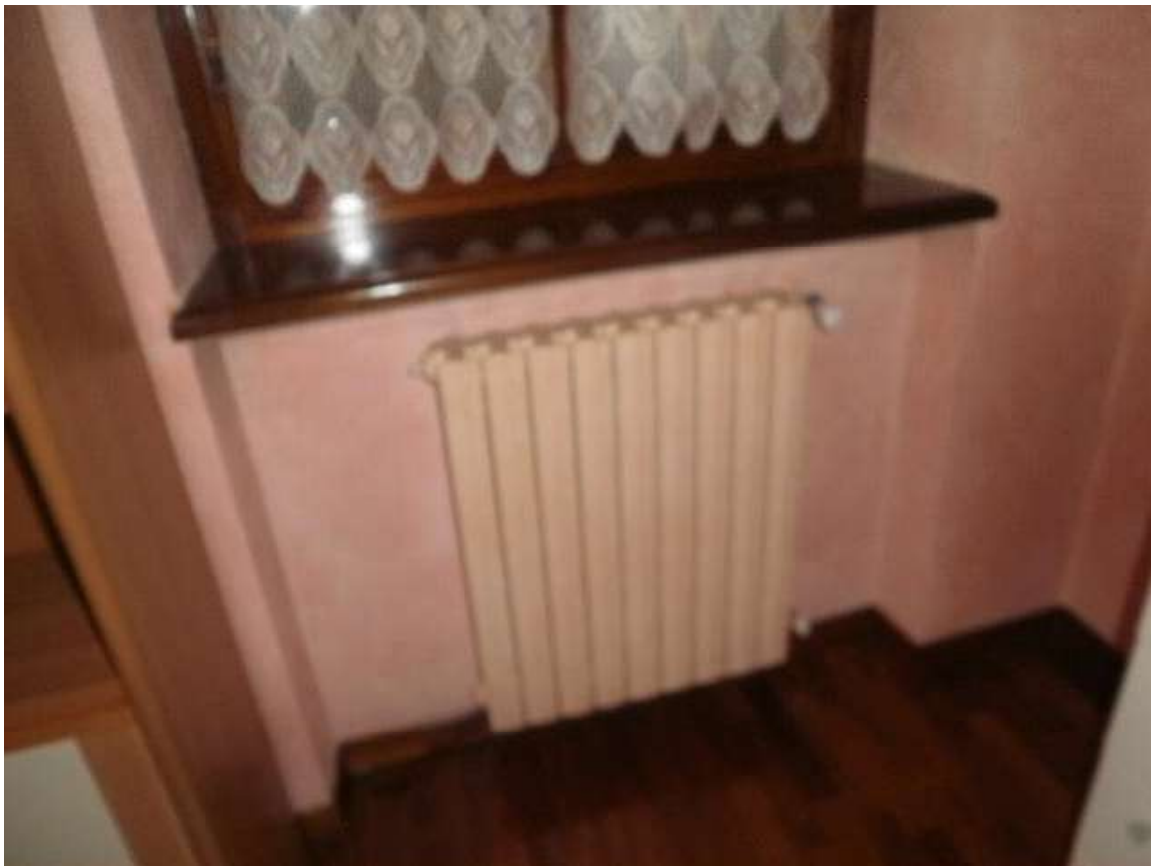
Vista tipologia generatore impianto di riscaldamento e termosifoni interni ai vani di civile abitazione
