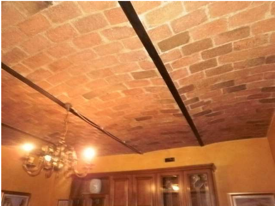
Vista interna tipologie rifiniture locali residenziali posti in piano terra del fabbricato di civile abitazione
