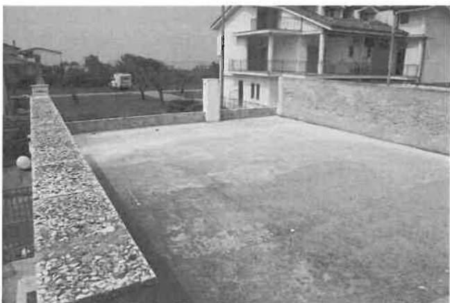
Foto n°36 Ringhiera prospettante sulla via di accesso
