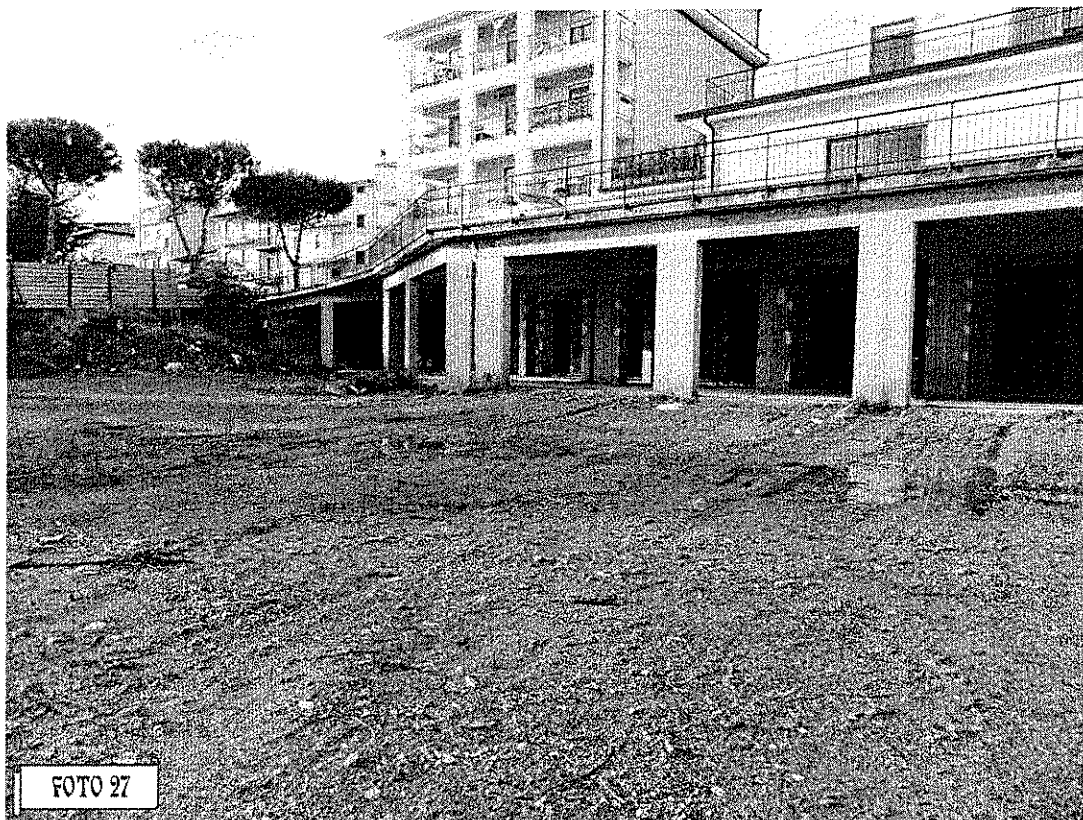
Lotto N. 5: Vista dei locali, allo stato rustico, al piano seminterrato, con destinazione "autorimesse".
