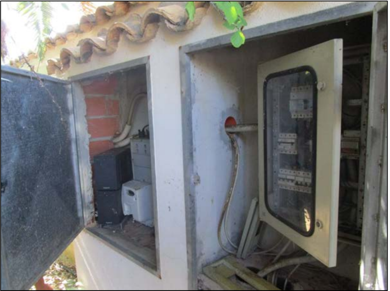
Foto 50: particolare quadro/punto di fornitura del locale
