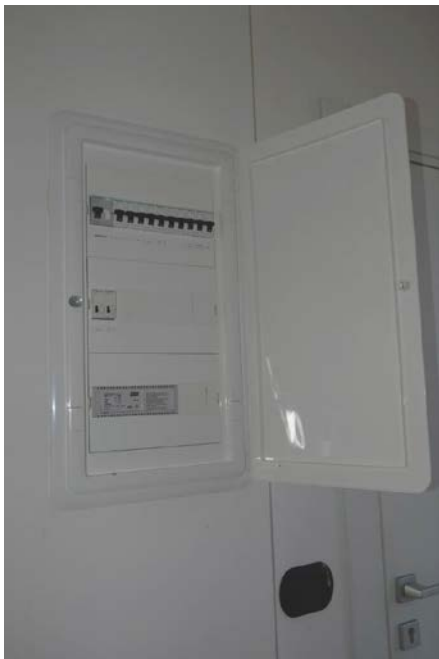
foto n.101 – quadro elettrico posto nel corridoio dell'appartamento, in prossimità della porta di ingresso
