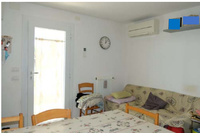
foto n.83 – veduta dell'accesso all'autorimessa dal cortile esterno e dell'interno dell'autorimessa utilizzata, impropriamente, come appartamento
