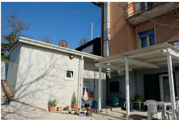
foto n.13 - veduta del ripostiglio identificato con il sub.9 (bene comune non censibile) e della tettoia realizzata senza titolo autorizzativo
