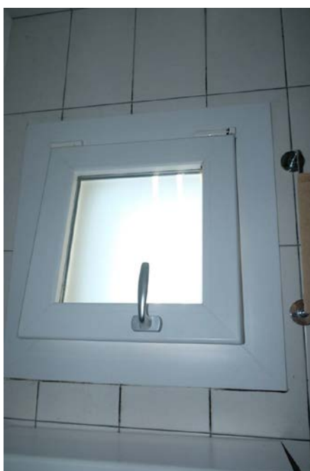
foto n.91-92 – particolare del controsoffitto e della finestra del w.c., ricavato nel sottoscala adiacente all'autorimessa utilizzata, impropriamente, come appartamento
