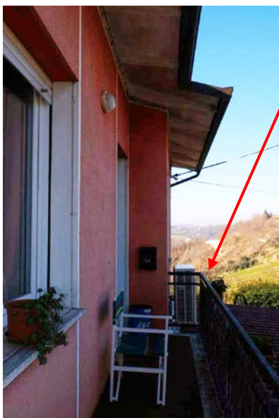
foto n.114 – veduta del corpo esterno dell'impianto di raffrescamento degli ambienti dell'appartamento
