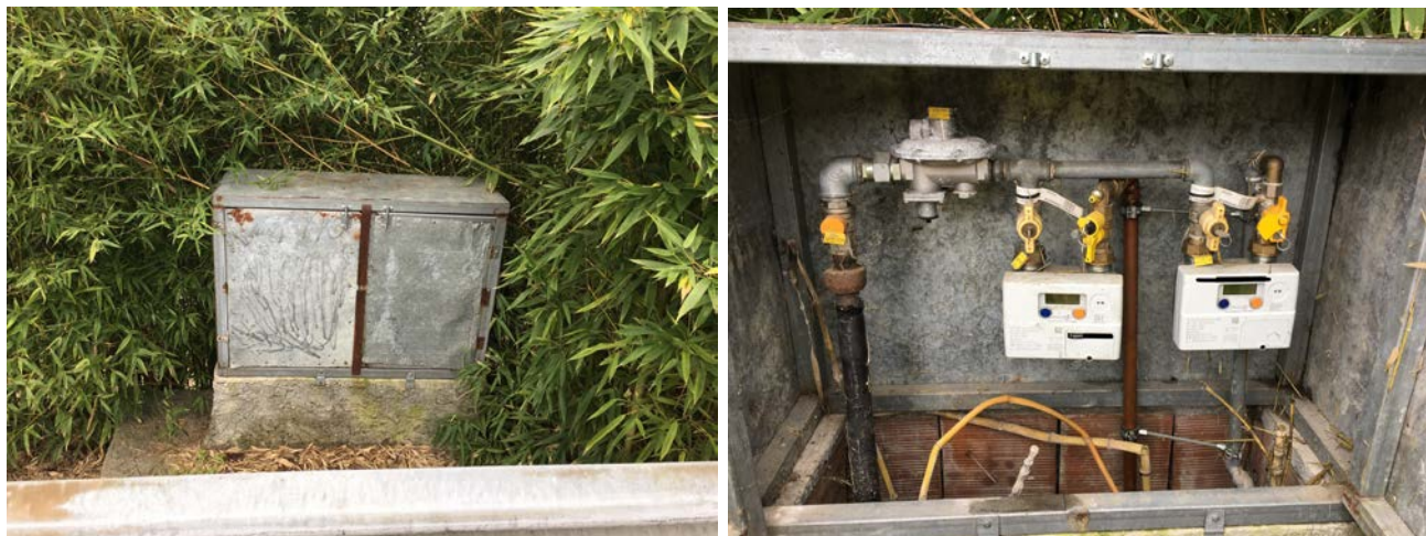
foto n.124-125 – veduta della nicchia e dei contatori del gas
