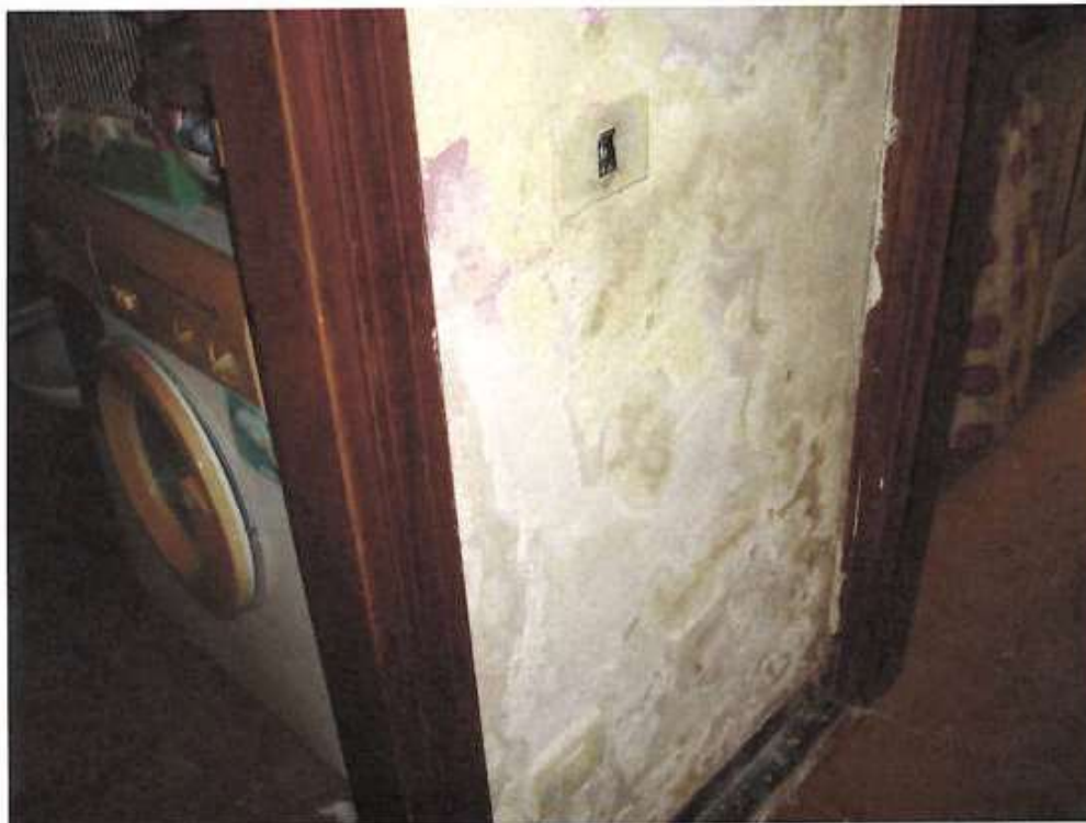
APPARTAMENTO PIANO PRIMO - PARETE CON INFILTRAZIONI ACQUA
