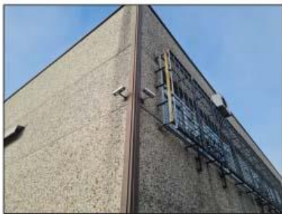
FOTO 35 - Impianto video sorv.
