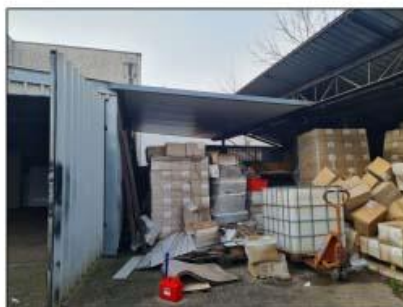
FOTO 11 - Tettoie abusive retro
