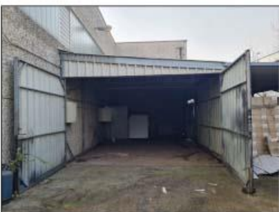
FOTO 10 - Tettoie abusive retro
