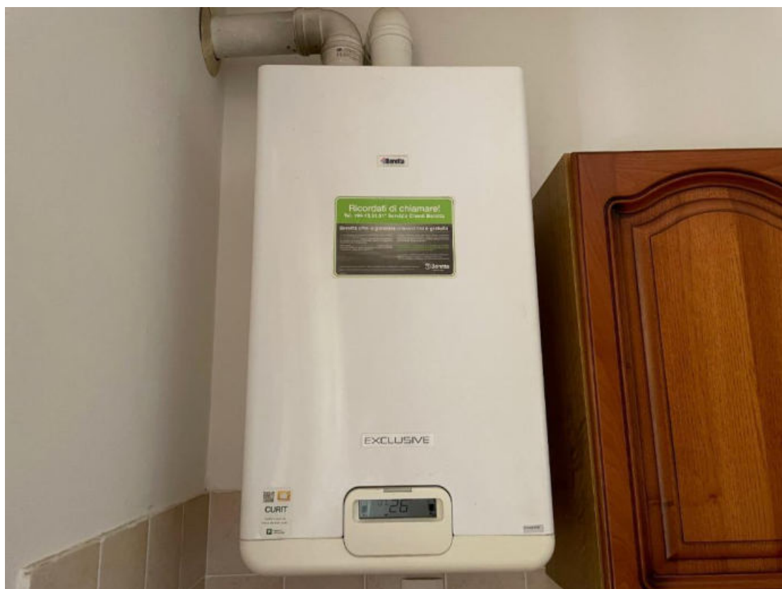
Caldaia Riscaldamento e ACS
