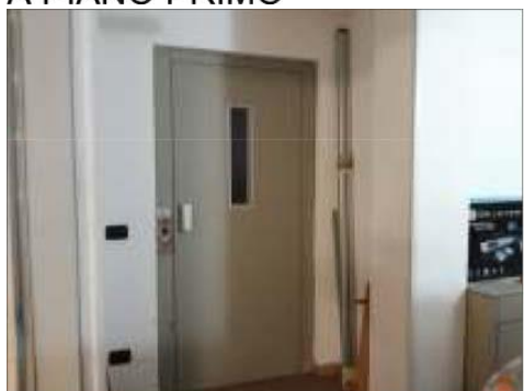
FOTO 23 - ASCENSORE A PIANO TERRA
