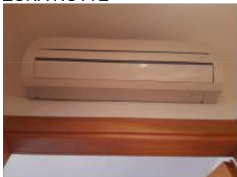
FOTO 39 - RAFFRESCAMENTO UNITA' INTERNA
