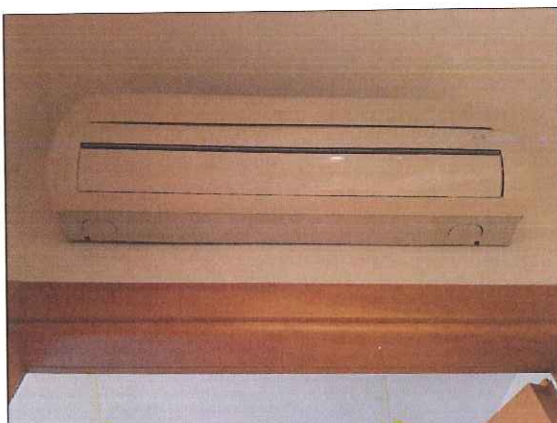
FOTO 39 - RAFFRESCAMENTO UNITA' INTERNA
