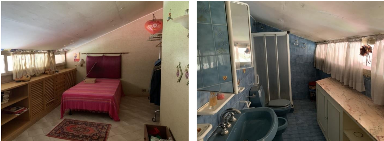
Patologie diffuse da umidità in corrispondenza dei soffitti del piano secondo
