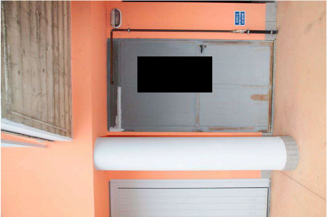
Foto n° 61 - Mappali 1142 sub 24 (Centrale Termica)
