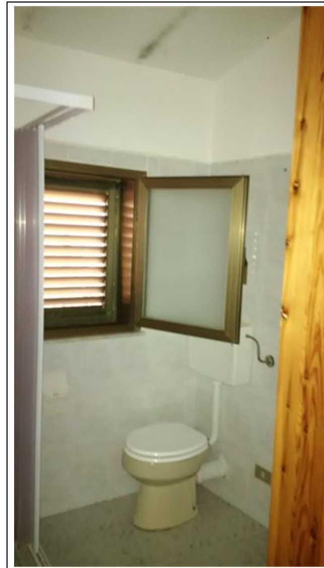
Foto 30- bagno/wc abusivo, 1° piano
