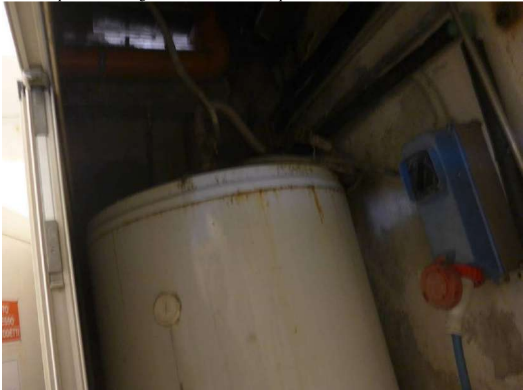
FOTO 172 – STABILIMENTO AL PIANOTERRA, disimpegno-locale idropulitrice. Vano con soprastante la terrazza al primo piano, dove si trovano i compressori delle celle frigorifero. Sulla sinistra si trova il vano aromi (chiuso per infiltrazioni d'acqua). Visibili anche in questo vano segni di infiltrazione d'acqua.
