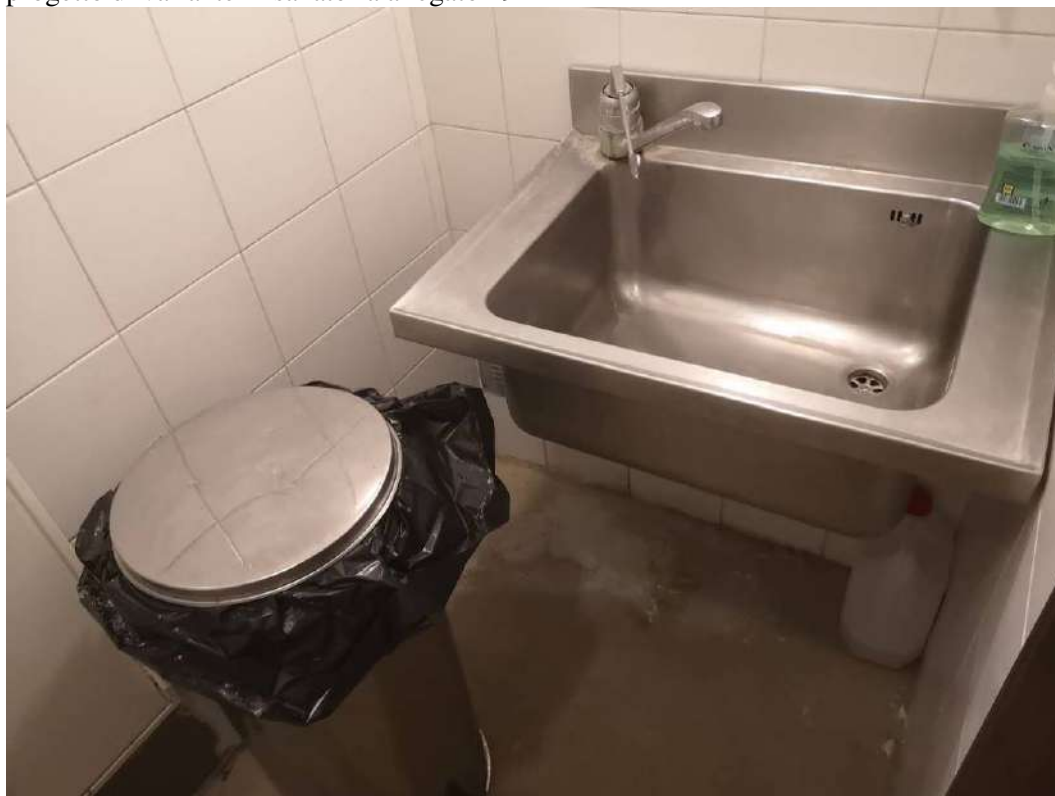
FOTO 137- STABILIMENTO AL PIANOTERRA, spogliatoio. Zona corrispondente al pianoterra ai vani identificati con il n. 3 nella planimetria catastale allegato 31, vedi progetto di variante in sanatoria allegato 49
