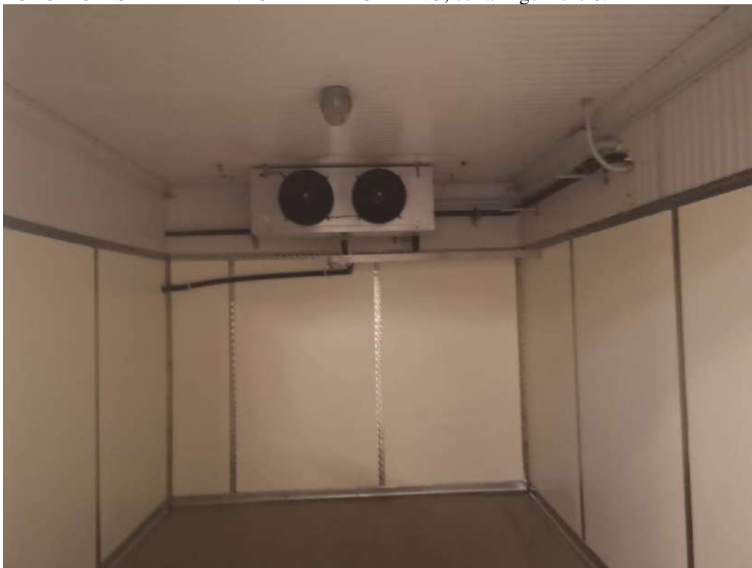
FOTO 219 – STABILIMENTO AL PRIMO PIANO, cella frigorifero 8.
