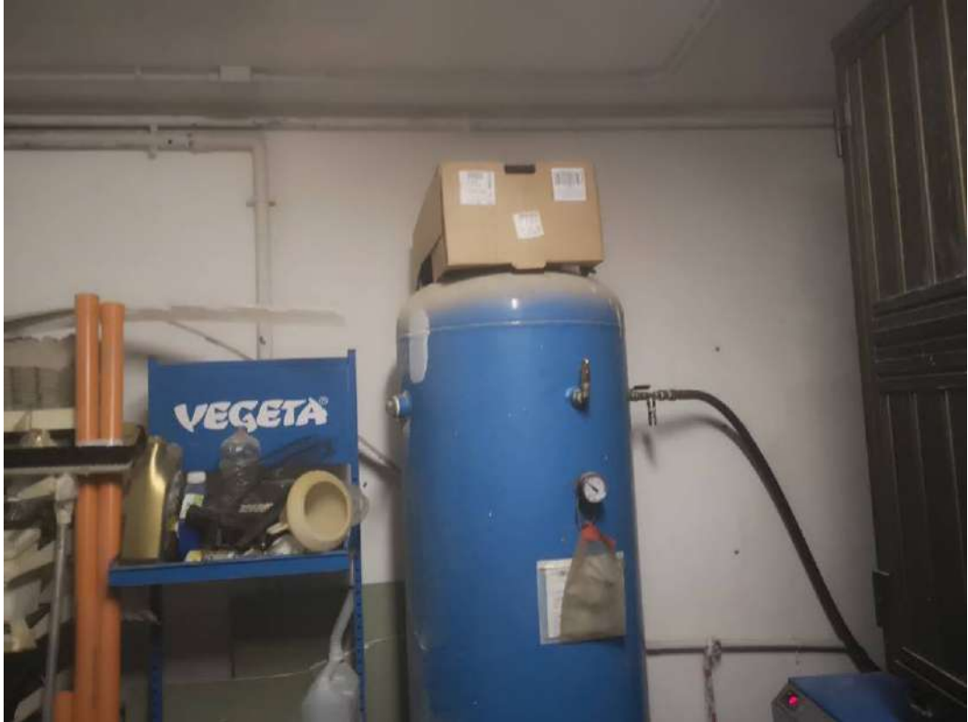
FOTO 181 – STABILIMENTO AL PIANOTERRA, locale compressori (vedi foto esterna n. 16), vedi progetto di variante in sanatoria allegato 49
