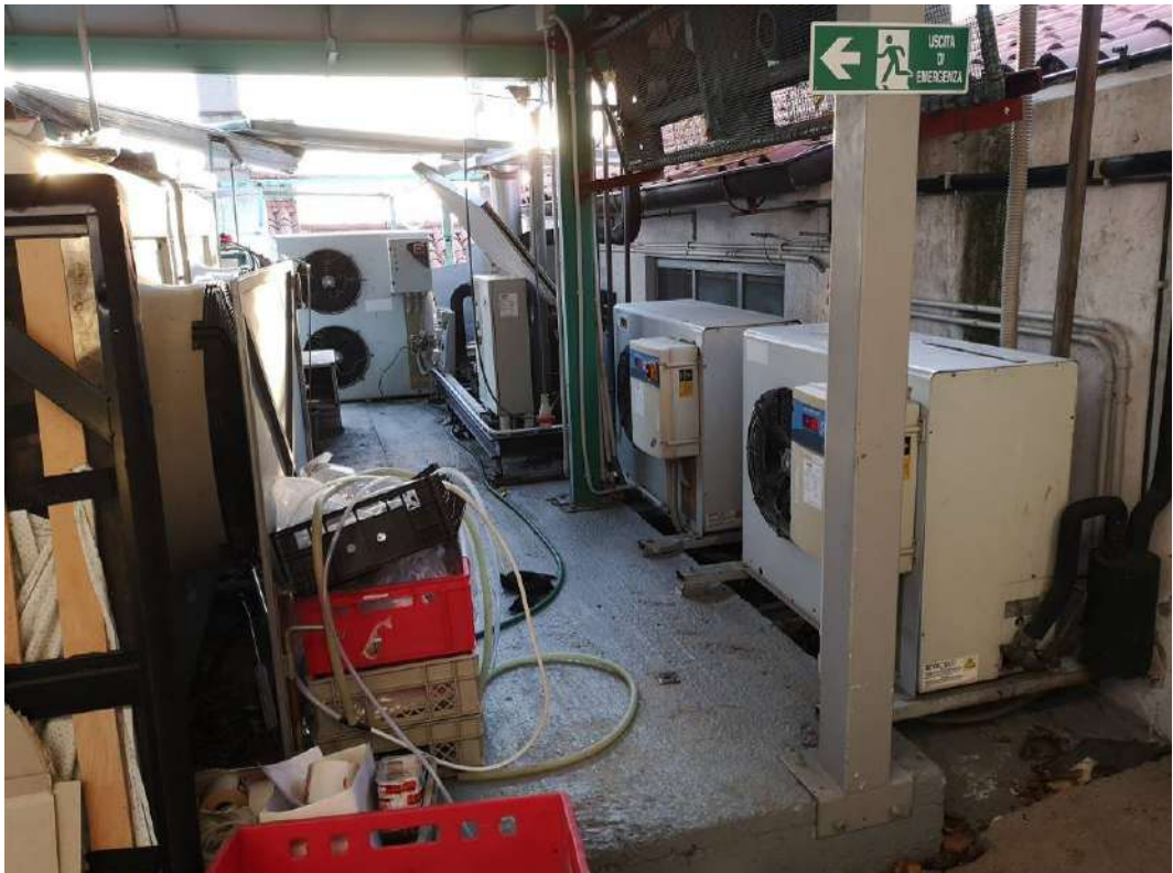
FOTO 240 – STABILIMENTO AL PRIMO PIANO, terrazza, zona coperta dalla tenda, vedi progetto di variante in sanatoria allegato 49 (pianta del primo piano e pianta copertura). E' visibile il serramento di finestra (parzialmente nascosto dalle unità esterne di condizionamento)
