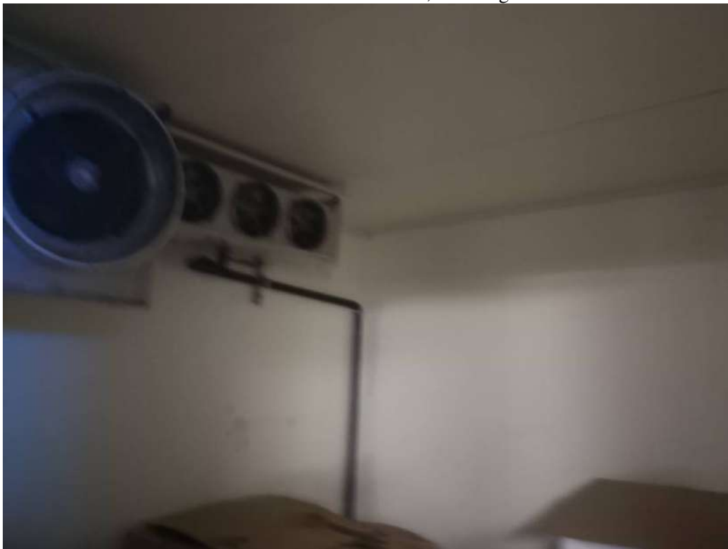
FOTO 143 – STABILIMENTO AL PIANOTERRA, cella frigorifera n. 3
