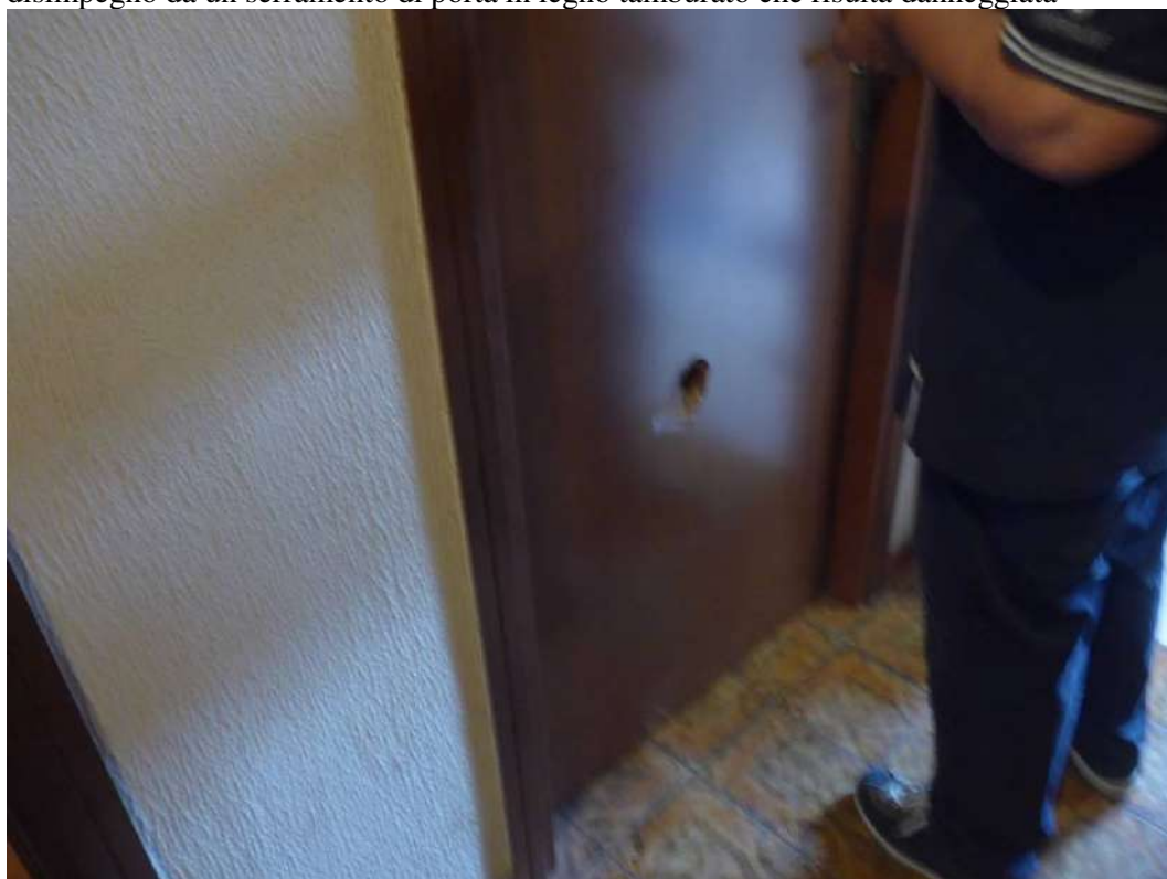
FOTO 80 – ALLOGGIO SUB 2 PRIMO PIANO, stanza prospettante la p.c.ed. 211/2 verso strada pubblica, vedi planimetria catastale allegato 33. Risulta accessibile dal disimpegno da un serramento di porta in legno tamburato che risulta danneggiata
