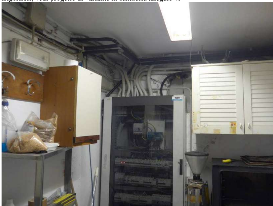
FOTO 152 – STABILIMENTO AL PIANOTERRA, locale quadro elettrico di potenza pianoterra (vedi vano al pianoterra indicato con il n. 4 nella planimetria catastale allegato 31), vano presente sotto la terrazza al primo piano dove insistono i compressori dei frigoriferi, vedi progetto di variante in sanatoria allegato 49
