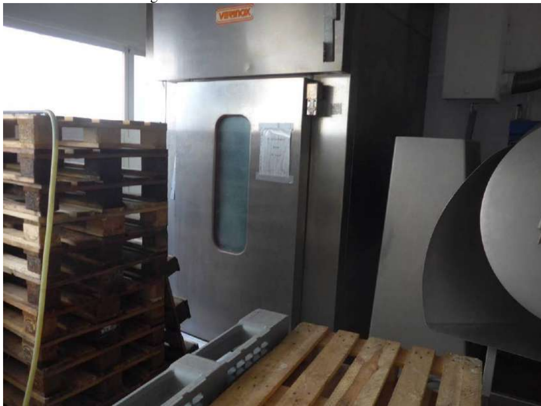
FOTO 174 – STABILIMENTO AL PIANOTERRA, disimpegno, vedi vano più grande al pianoterra indicato con il n. 2 nella planimetria catastale allegato 31, vano in collegamento con la zona scarico merci (vedi foto 122 e 123). In questo vano risulta posto il forno VERINOX, la massaggiatrice RHULE ed il forno ELLER. Vedi progetto di variante in sanatoria allegato 49
