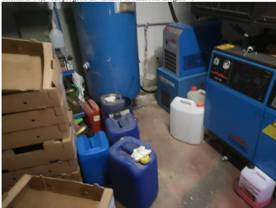
FOTO 179 – STABILIMENTO AL PIANOTERRA, locale compressori (vedi foto esterna n. 16), vedi progetto di variante in sanatoria allegato 49
