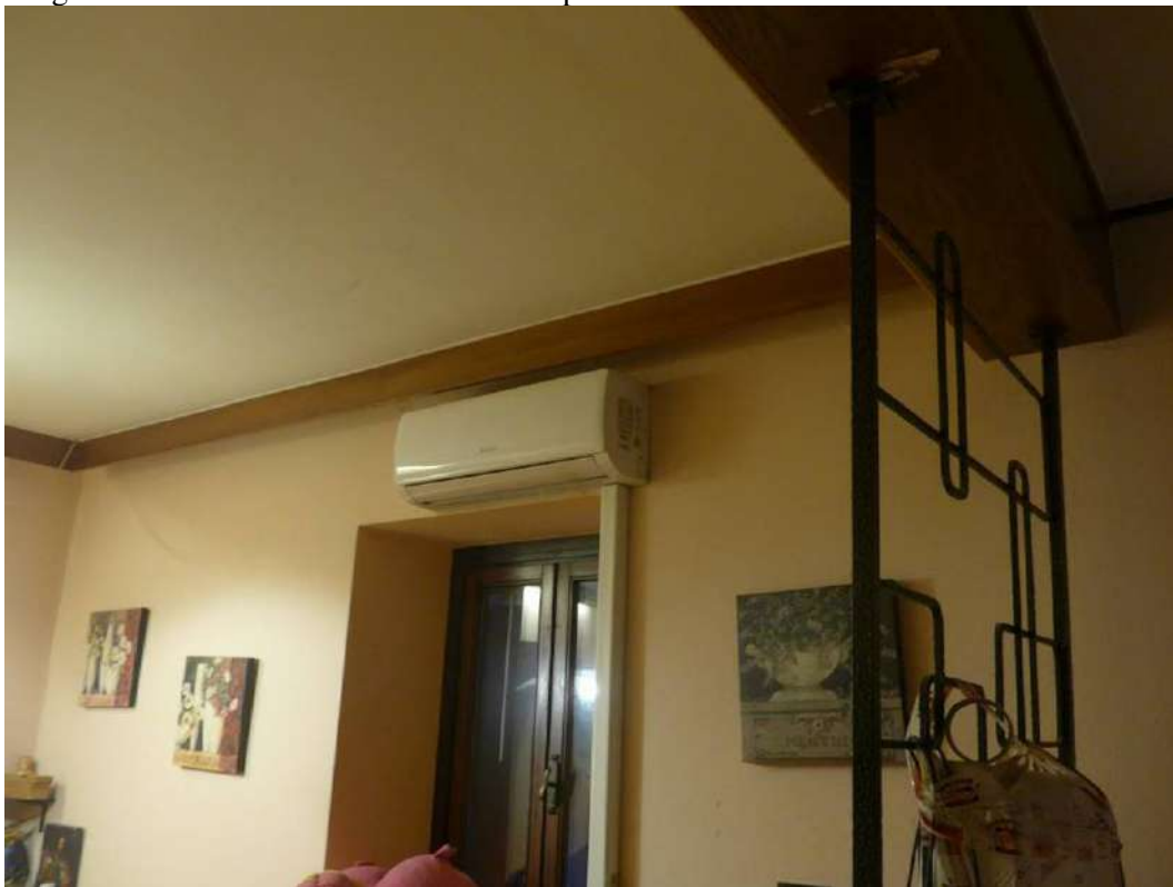
FOTO 78 – ALLOGGIO SUB 2 PRIMO PIANO, soggiorno, vedi planimetria catastale allegato 33. Visibile l'unità interna dell'impianto di condizionamento
