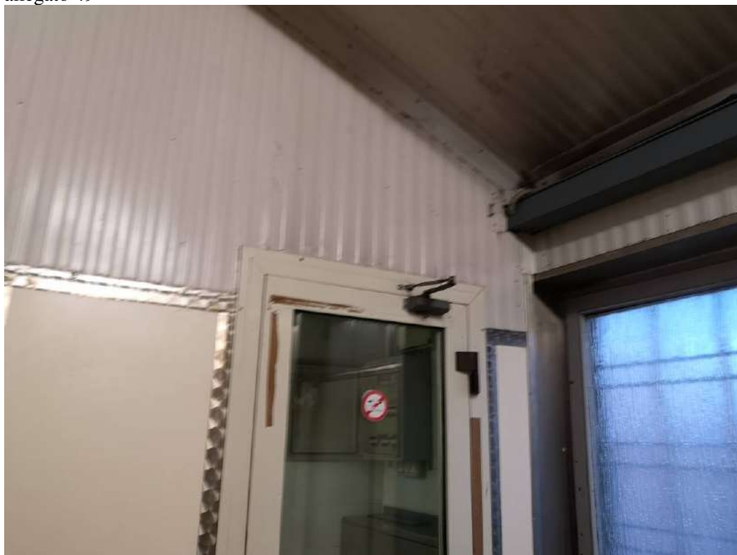
FOTO 187 – STABILIMENTO AL PRIMO PIANO, laboratorio, particolare del serramento che permette l'accesso al vano scale di comunicazione con il pianoterra. Vedi planimetria catastale allegato 31, il vano identificato con il numero 1 che riporta una altezza variabile di m. 260, m. 3,95 e m. 2,60, vedi progetto di variante in sanatoria allegato 49
