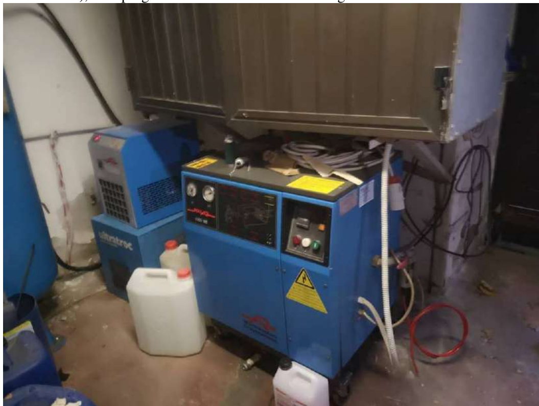
FOTO 180 – STABILIMENTO AL PIANOTERRA, locale compressori (vedi foto esterna n. 16), vedi progetto di variante in sanatoria allegato 49
