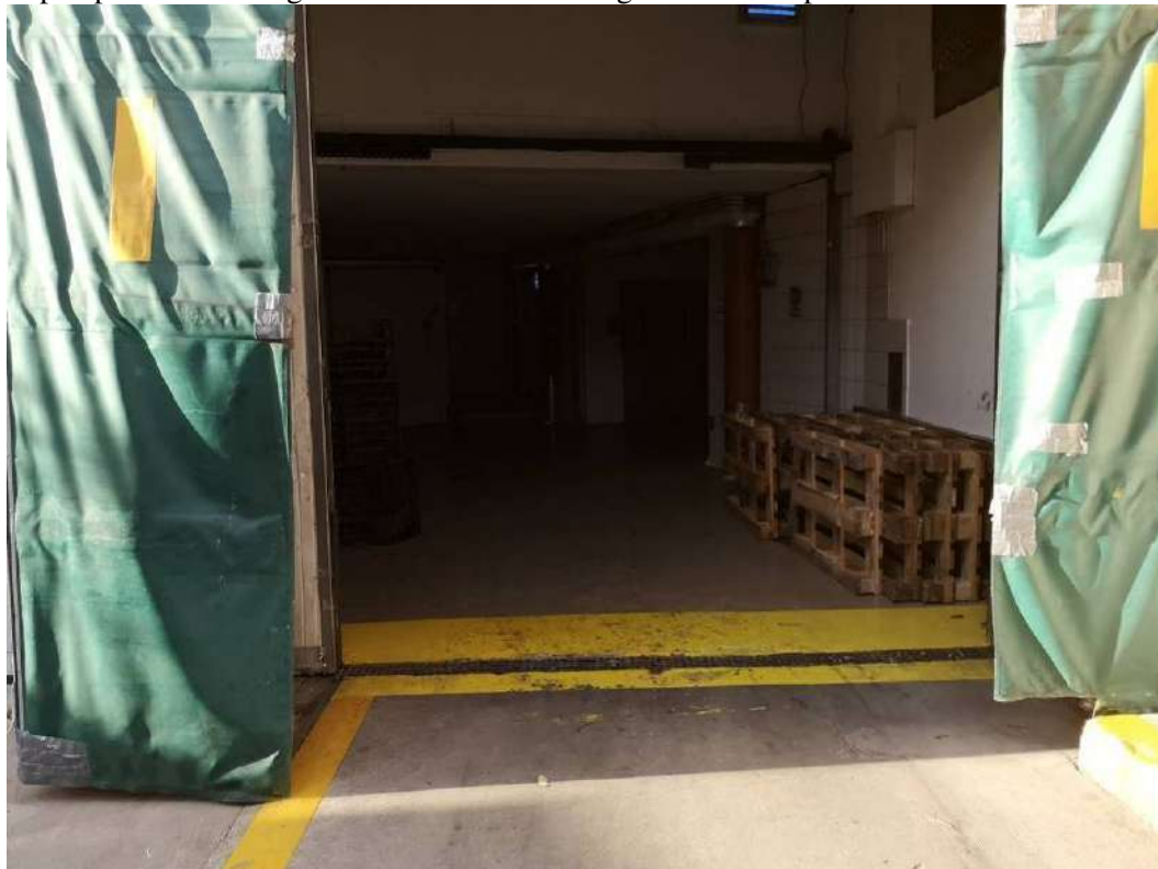
FOTO 18 – immagine ripresa dal cortile p.c.ed. 211/2 censita nel c.t. 1° della P.T 1277 del C.C. di Monti, edificio costruito sulla p.c.ed. 211/2, in primo piano la barriera in teli di pvc presenti sull'ingresso del laboratorio artigianale sito al pianoterra
