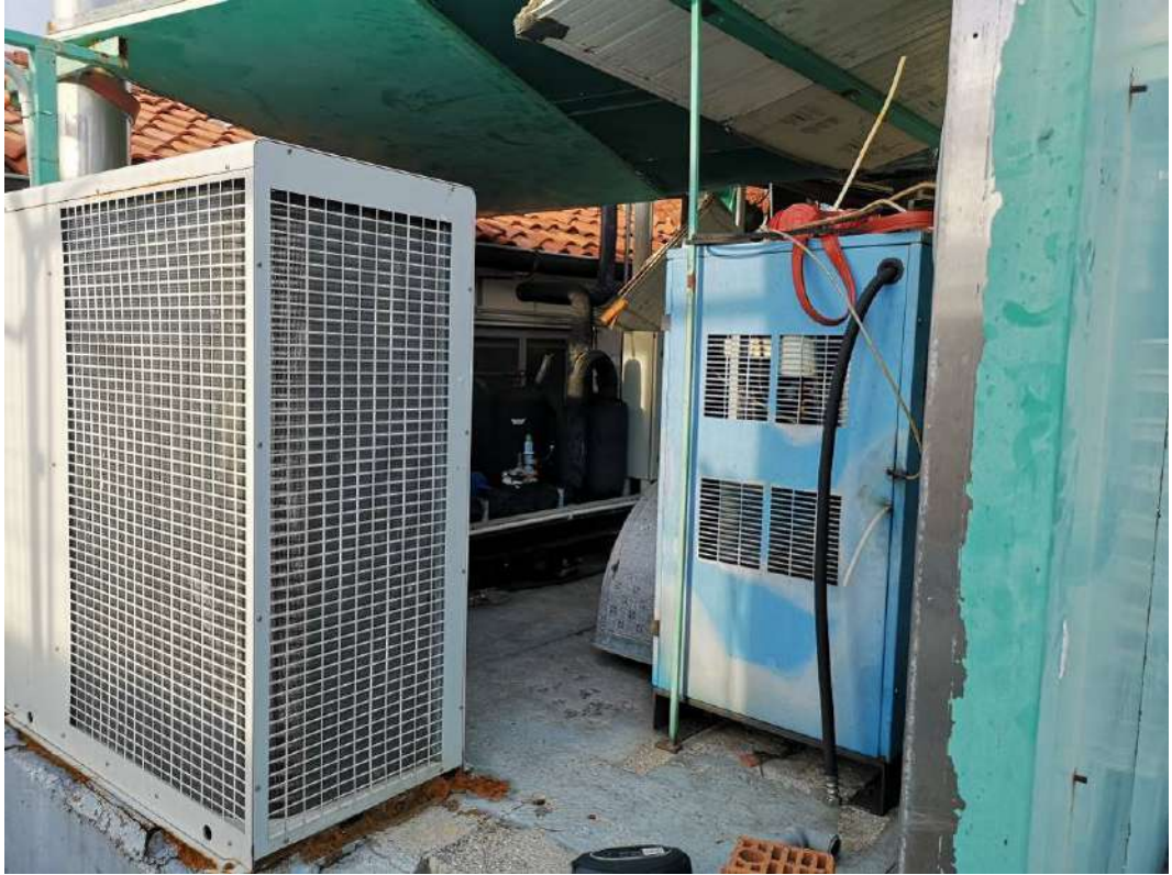
FOTO 245 – STABILIMENTO AL PRIMO PIANO, terrazza. Particolare della precaria tettoia presente sulla terrazza non rappresentata negli elaborati grafici depositati presso i pubblici uffici. Vedi planimetria catastale allegato 31 e vedi progetto di variante in sanatoria allegato 49 e vedi pure foto 224 e 225
