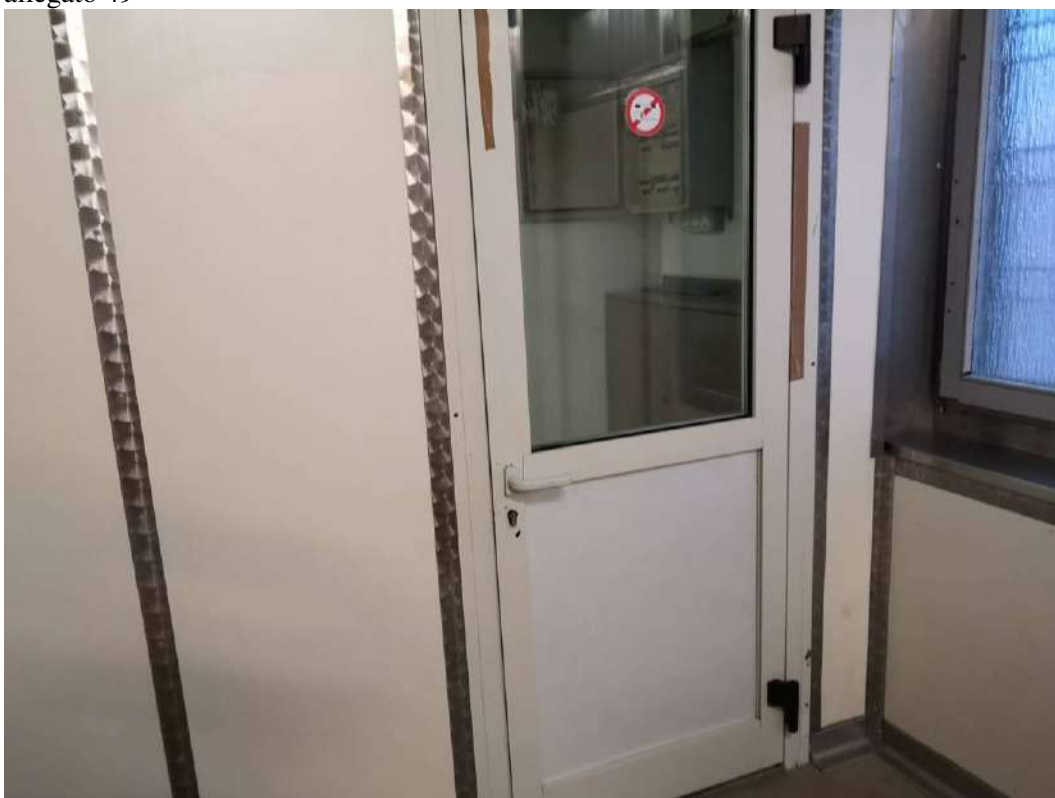
FOTO 186 – STABILIMENTO AL PRIMO PIANO, laboratorio, particolare del serramento che permette l'accesso al vano scale di comunicazione con il pianoterra. Vedi planimetria catastale allegato 31, il vano identificato con il numero 1 che riporta una altezza variabile di m. 2,60, m. 3,95 e m. 2,60, vedi progetto di variante in sanatoria allegato 49
