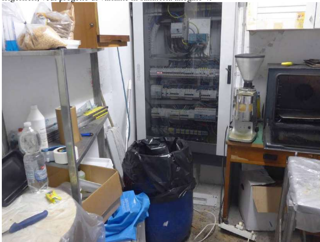
FOTO 153 – STABILIMENTO AL PIANOTERRA, locale quadro elettrico di potenza pianoterra (vedi vano al pianoterra indicato con il n. 4 nella planimetria catastale allegato 31), vano presente sotto la terrazza al primo piano dove insistono i compressori dei frigoriferi, vedi progetto di variante in sanatoria allegato 49
