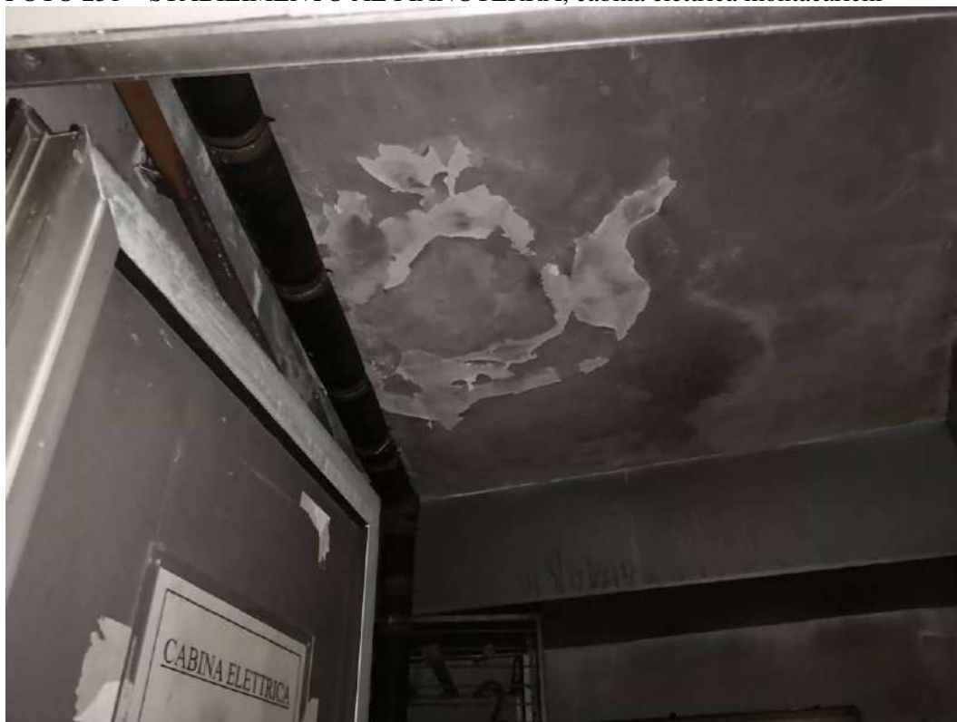
FOTO 251 – STABILIMENTO AL PIANOTERRA, cabina elettrica montacarichi
