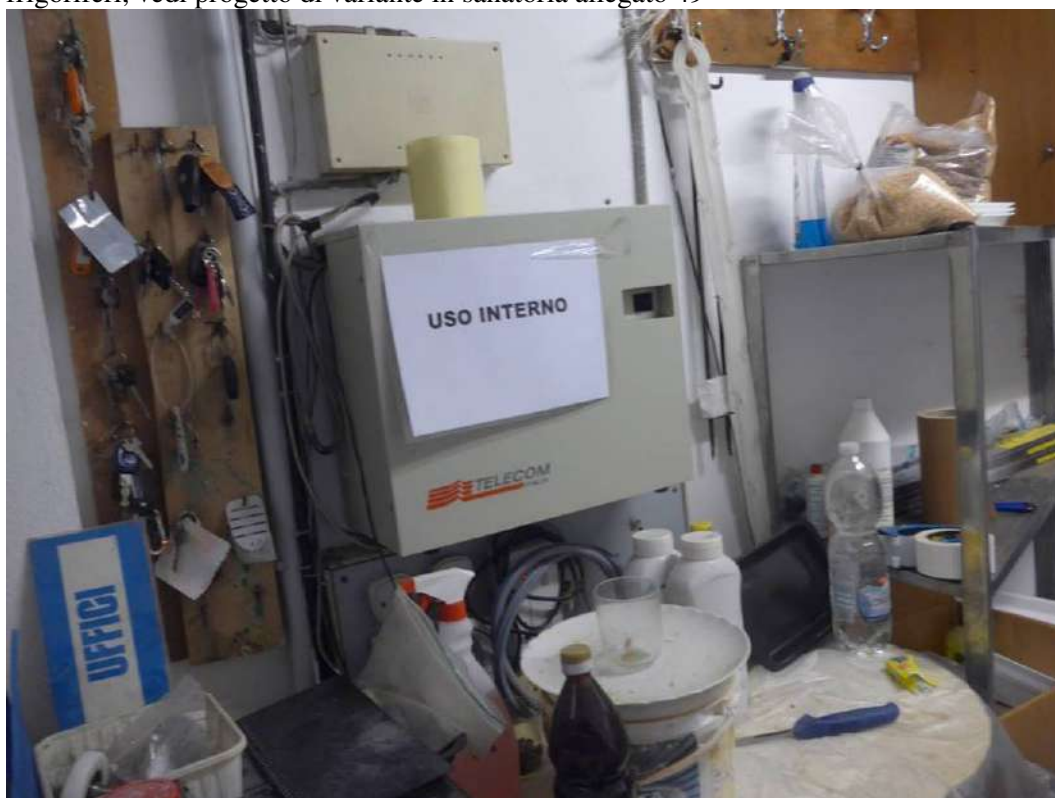
FOTO 154 – STABILIMENTO AL PIANOTERRA, locale quadro elettrico di potenza pianoterra (vedi vano al pianoterra indicato con il n. 4 nella planimetria catastale allegato 31), vano presente sotto la terrazza al primo piano dove insistono i compressori dei frigoriferi, vedi progetto di variante in sanatoria allegato 49
