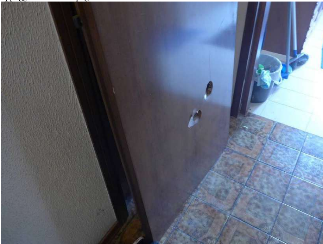
FOTO 97 – ALLOGGIO SUB 2 PRIMO PIANO, stanza prospettante sulla scala esterna e verso il cortile interno p.c.ed. 211/2, vedi planimetria catastale allegato 33 e vedi estratto mappa allegato 6, particolare del serramento di porta in legno tamburato che è risultata appoggiata nel disimpegno
