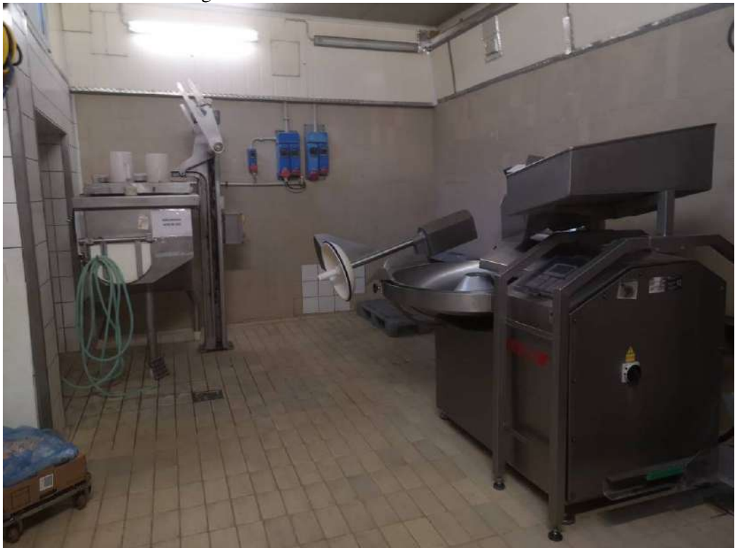
FOTO 148 – STABILIMENTO AL PIANOTERRA, laboratorio al pianoterra (zona individuata nella planimetria catastale con il numero 1, vedi allegato 31), vedi progetto di variante in sanatoria allegato 49
