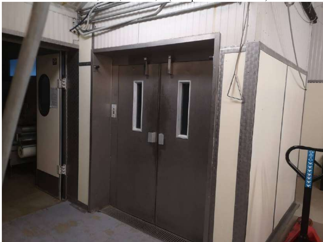
FOTO 188 – STABILIMENTO AL PRIMO PIANO, laboratorio, particolare del montacarichi permette l'accesso al vano scale di comunicazione con il pianoterra. Vedi planimetria catastale allegato 31, il vano identificato con il numero 1 che riporta una altezza variabile di m. 260, m. 3,95 e m. 2,60 (nella planimetria catastale)
