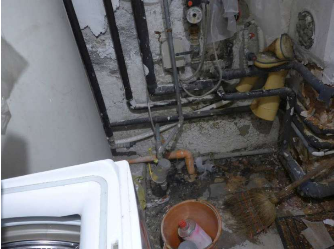
FOTO 159 – STABILIMENTO AL PIANOTERRA, centrale termica (caldaia e boiler), (vedi vano al pianoterra indicato con il n. 4 nella planimetria catastale allegato 31), vano presente sotto la terrazza al primo piano dove insistono i compressori dei frigoriferi. Visibili le consistenti infiltrazioni d'acqua. Vedi progetto di variante in sanatoria allegato 49
