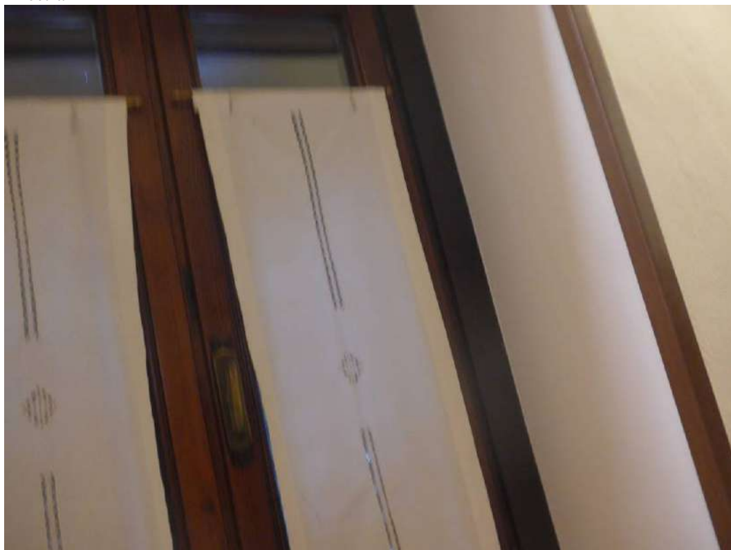
FOTO 85 – ALLOGGIO SUB 2 PRIMO PIANO, stanza prospettante la p.c.ed. 11/2 verso strada pubblica, vedi planimetria catastale allegato 33. Particolare serramento di finestra
