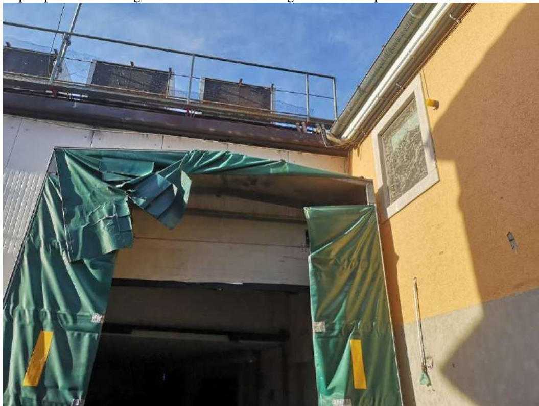
FOTO 17 – immagine ripresa dal cortile p.c.ed. 211/2 censita nel c.t. 1° della P.T 1277 del C.C. di Monti, edificio costruito sulla p.c.ed. 211/2, in primo piano la barriera in teli di pvc presenti sull'ingresso del laboratorio artigianale sito al pianoterra
