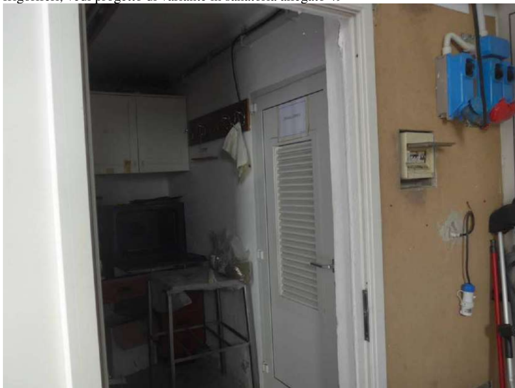
FOTO 151 – STABILIMENTO AL PIANOTERRA, locale quadro elettrico di potenza pianoterra (vedi vano al pianoterra indicato con il n. 4 nella planimetria catastale allegato 31 ), vano presente sotto la terrazza al primo piano dove insistono i compressori dei frigoriferi, vedi progetto di variante in sanatoria allegato 49
