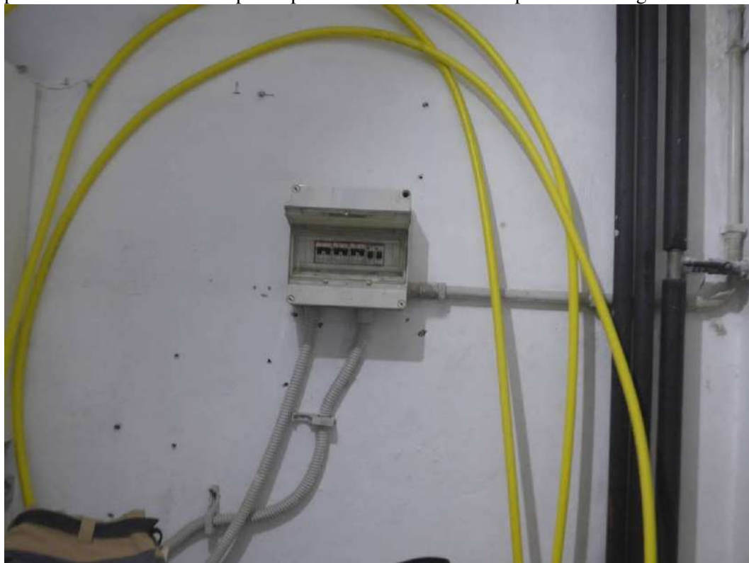
FOTO 162 – STABILIMENTO AL PIANOTERRA, centrale termica (caldaia e boiler), (vedi vano al pianoterra indicato con il n. 4 nella planimetria catastale allegato 31), vano presente sotto la terrazza al primo piano dove insistono i compressori dei frigoriferi
