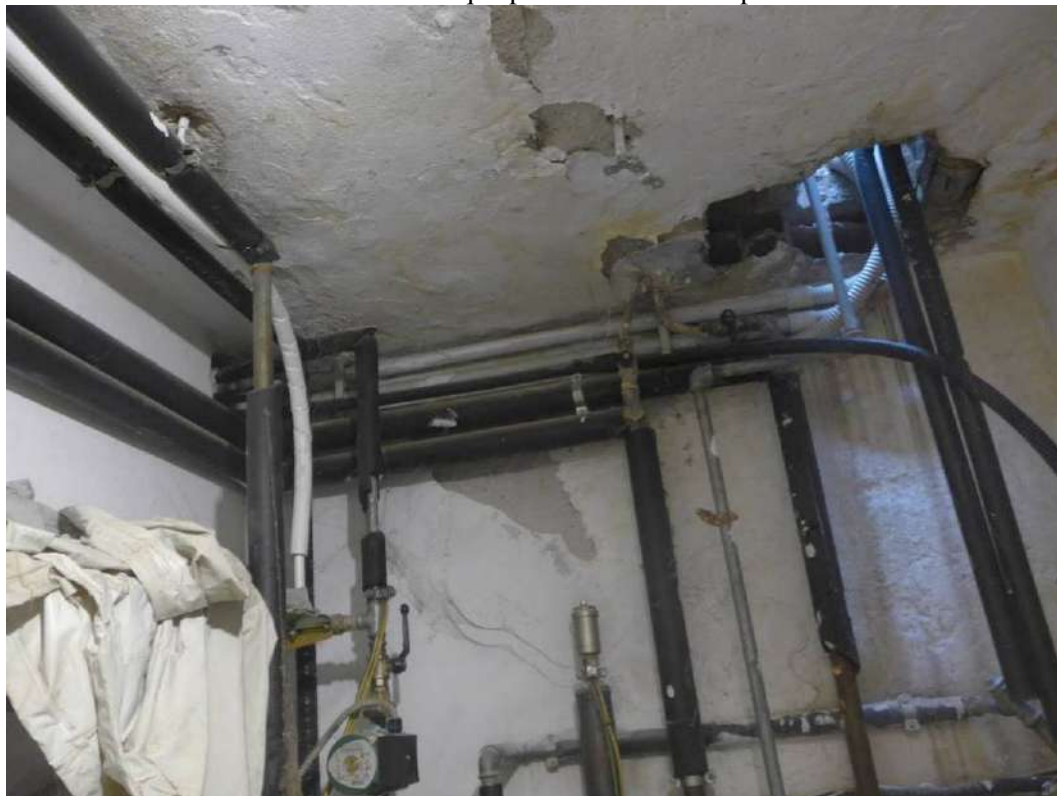
FOTO 161 – STABILIMENTO AL PIANOTERRA, centrale termica (caldaia e boiler), (vedi vano al pianoterra indicato con il n. 4 nella planimetria catastale allegato 31), vano presente sotto la terrazza al primo piano dove insistono i compressori dei frigoriferi. Visibili le consistenti infiltrazioni d'acqua provenienti dalla soprastante terrazza
