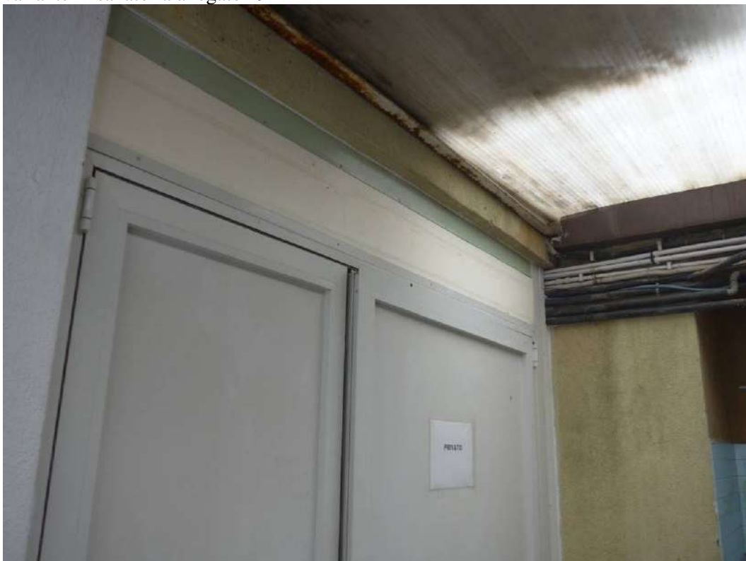
FOTO 62 – UFFICIO SUB 1, ingresso al vano ripostiglio ricavato con una pannellatura a scapito del portico, vedi planimetria catastale allegato 32, vedi foto 30 e 59. Il ripostiglio non è rappresentato nella planimetria catastale, mentre è rappresentato nel progetto di variante in sanatoria allegato 49
