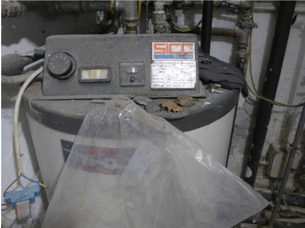
FOTO 163 – STABILIMENTO AL PIANOTERRA, centrale termica (caldaia e boiler), (vedi vano al pianoterra indicato con il n. 4 nella planimetria catastale sub 32), vano presente sotto la terrazza al primo piano dove insistono i compressori dei frigoriferi. Particolare del boiler, vedi progetto di variante in sanatoria allegato 49
