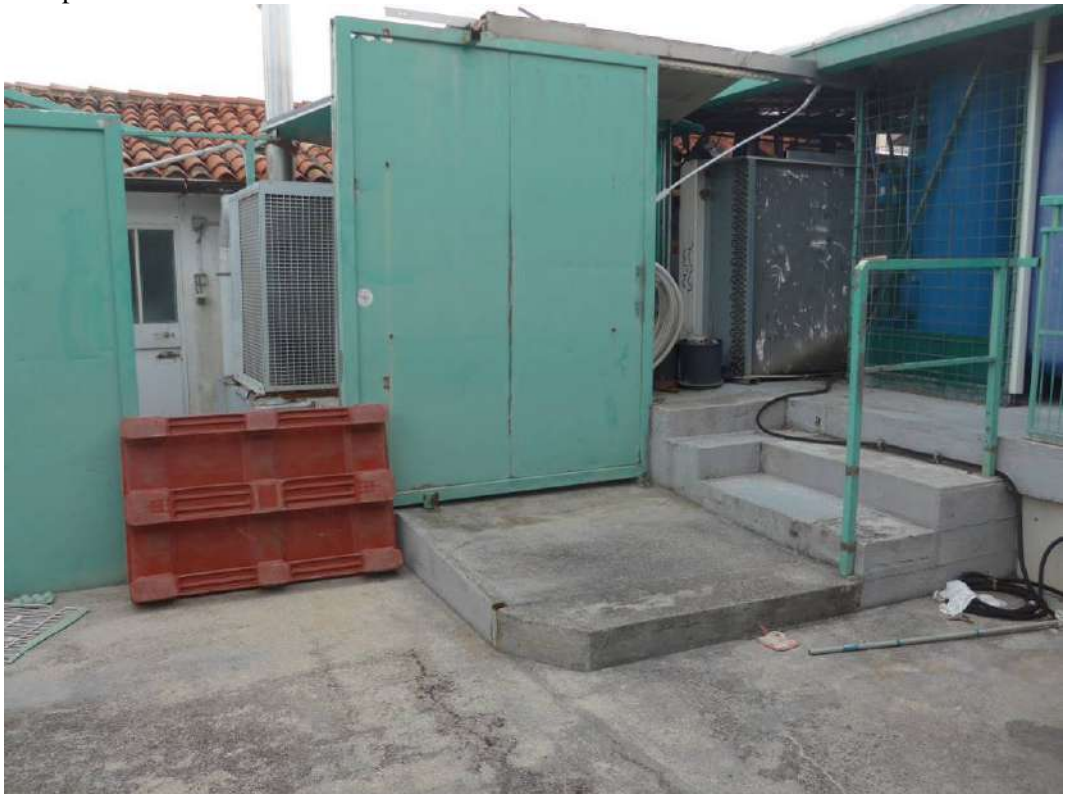
FOTO 246 – STABILIMENTO AL PRIMO PIANO, terrazza. Particolare della precaria tettoia (presente oltre il pannello verde verticale) presente sulla terrazza e da rimuovere. Vedi planimetria catastale allegato 31 e vedi progetto di variante in sanatoria allegato 49, vedi pure foto 224 e 225
