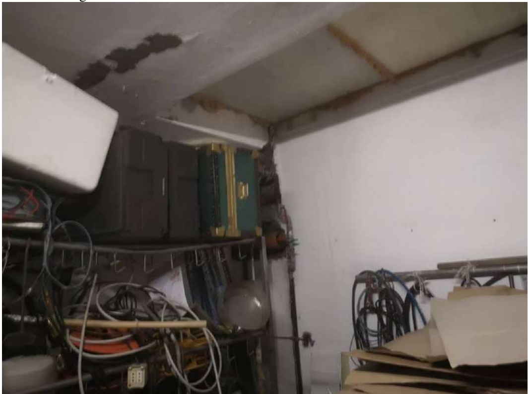
FOTO 182 – STABILIMENTO AL PIANOTERRA, locale compressori (vedi foto esterna n. 16). Sono presenti delle problematiche di macchie di umidità a probabile condensa a causa probabilmente delle soprastanti celle frigo presenti al primo piano (cella 8 e 9, celle che è stato segnalato che non sono funzionanti), vedi progetto di variante in sanatoria allegato 49
