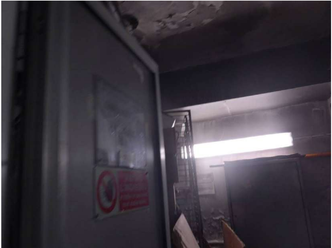
FOTO 129 – STABILIMENTO AL PIANOTERRA, sala macchina montacarichi
