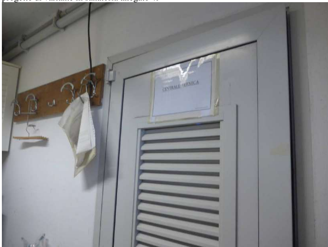
FOTO 155 – STABILIMENTO AL PIANOTERRA, centrale termica (caldaia e boiler), (vedi vano al pianoterra indicato con il n. 4 nella planimetria catastale allegato 31), vano presente sotto la terrazza al primo piano dove insistono i compressori dei frigoriferi, vedi progetto di variante in sanatoria allegato 49
