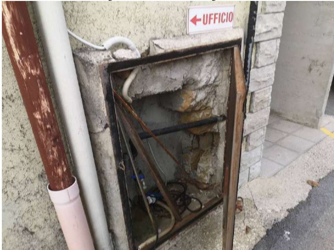
FOTO 11 – particolare della foto 4 e 5, sull'edificio eretto sulla p.c.ed. 211/1 risulta presente una nicchia nella quale risulta presente un rubinetto d'acqua ed impropriamente alcuni cavi elettrici con collegamenti certamente non adeguati
