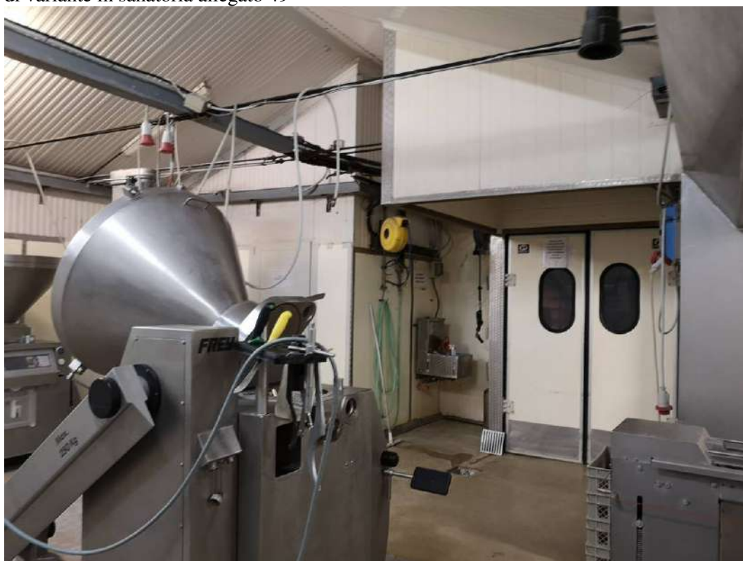
FOTO 192 – STABILIMENTO AL PRIMO PIANO, laboratorio. Vedi planimetria catastale allegato 31, il vano identificato con il numero 1 che riporta una altezza variabile di m. 2,60, m. 3,95 e m. 2,60 (altezze riportate nella planimetria catastale), vedi progetto di variante in sanatoria allegato 49
