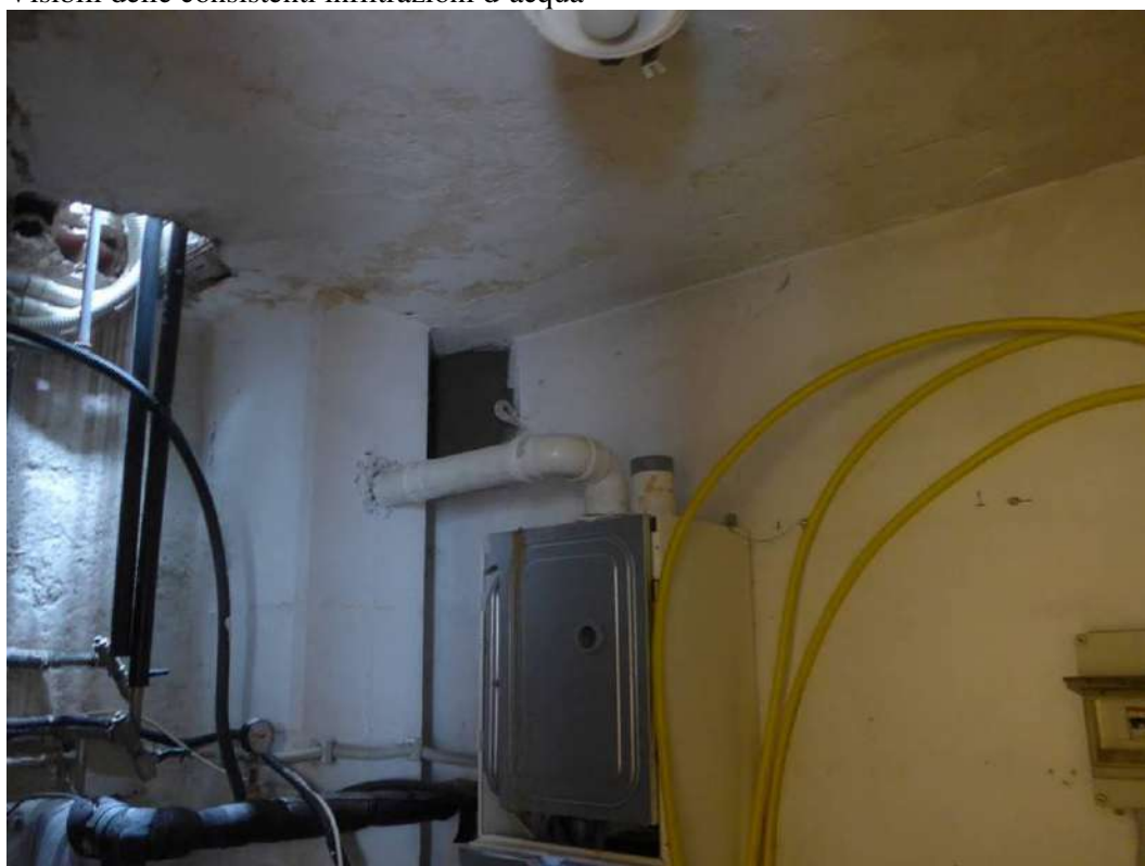
FOTO 156 – STABILIMENTO AL PIANOTERRA, centrale termica (caldaia e boiler), (vedi vano al pianoterra indicato con il n. 4 nella planimetria catastale allegato 31), vano presente sotto la terrazza al primo piano dove insistono i compressori dei frigoriferi. Visibili delle consistenti infiltrazioni d'acqua
