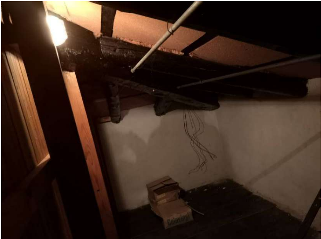
FOTO 114 – ALLOGGIO SUB 2 SECONDO PIANO, foto ripresa dal secondo piano, livello di piano non rappresentato nella planimetria catastale allegato 33. La soffitta/intercapedine è suddivisa in tre vani con delle pannellature rivestite in perline di legno. Visibili le tavole di legno sul pavimento presenti sulla struttura del solaio da verificare se idoneo ad essere utilizzato come vano accessorio
