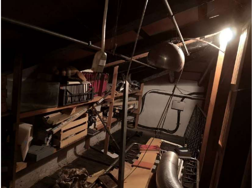
FOTO 113 – ALLOGGIO SUB 2 SECONDO PIANO, foto ripresa dal secondo piano, livello di piano non rappresentato nella planimetria catastale allegato 33. La soffitta/intercapedine è suddivisa in tre vani con delle pannellature rivestite in perline di legno. Parte della soffitta soprastante al soggiorno. Visibili le tavole di legno della struttura del solaio, da verificare se idoneo ad un utilizzo come vano accessorio
