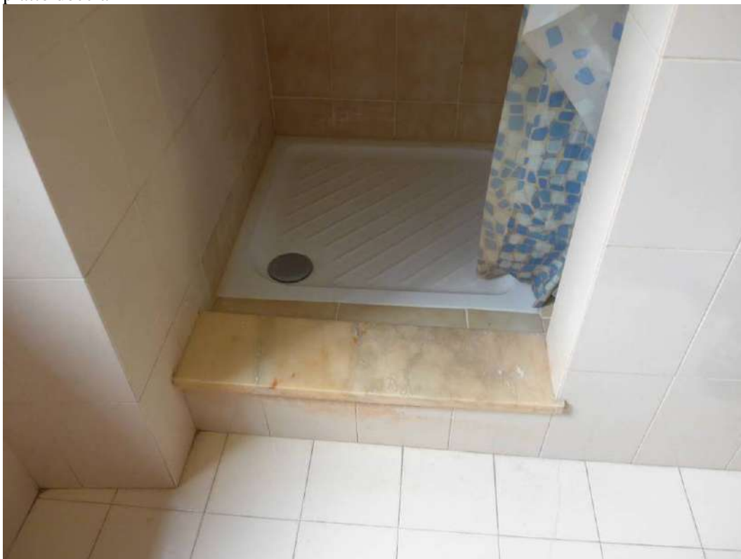
FOTO 88 – ALLOGGIO SUB 2 PRIMO PIANO, bagno, vedi planimetria catastale allegato 33. Nella planimetria catastale non sono rappresentate le pareti dove si trova il piatto doccia
