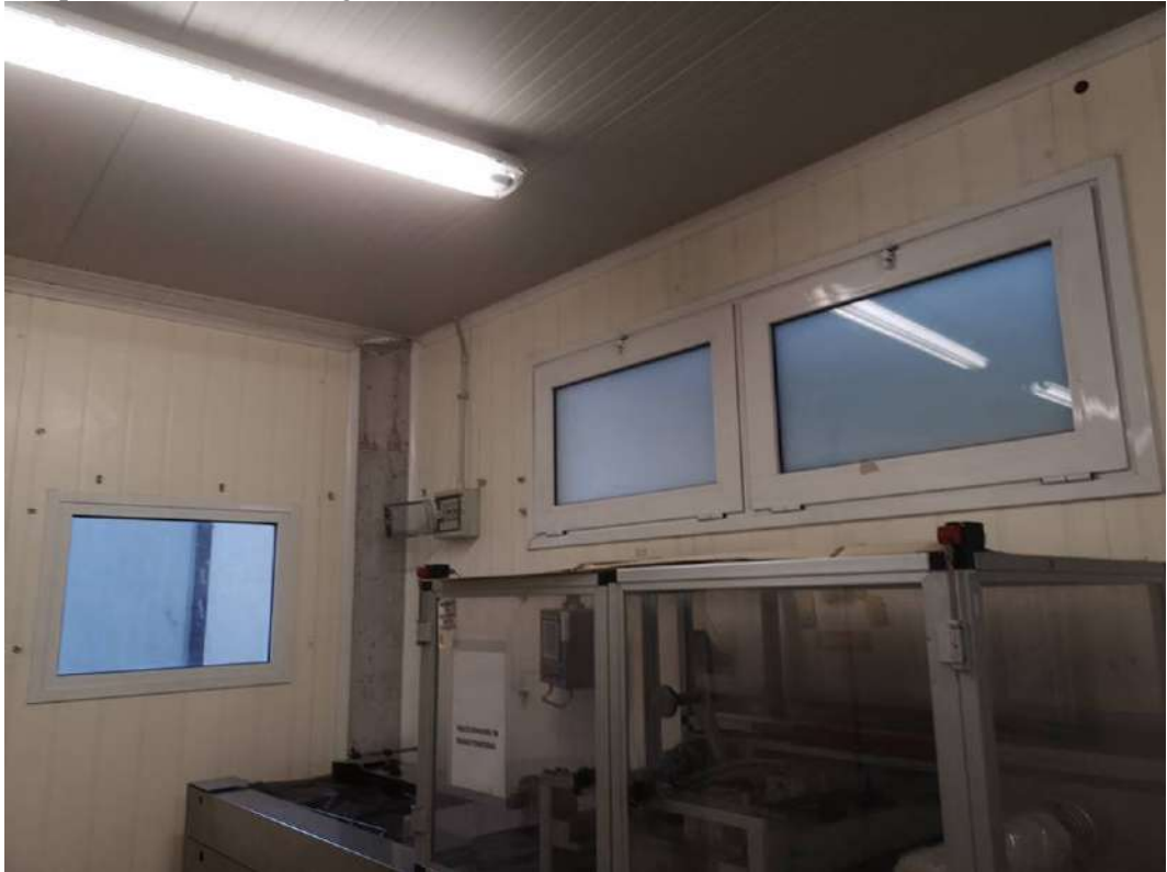
FOTO 201 – STABILIMENTO AL PRIMO PIANO, laboratorio. Vedi planimetria catastale allegato 31, vano identificato con il numero 1 che riporta una altezza di m. 2,85. Le finestre sulla destra prospettano verso la terrazza del primo piano dove si trovano i compressori delle celle frigorifero
