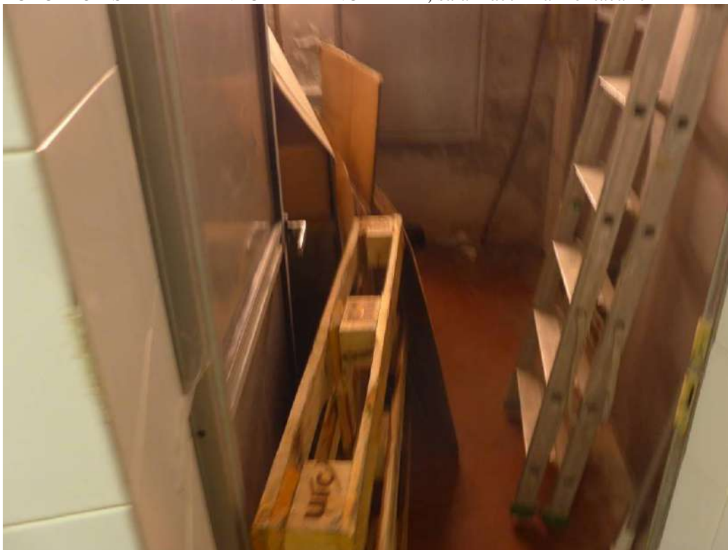
FOTO 128 – STABILIMENTO AL PIANOTERRA, sala macchina montacarichi
