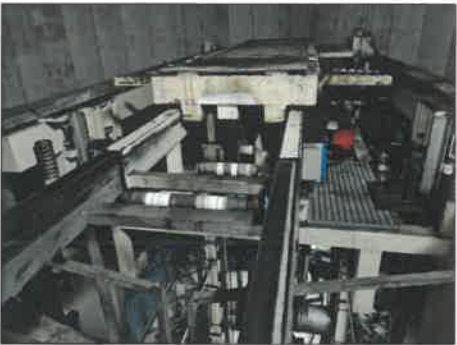
FOTO 16 - IMPIANTI PER LA MOVIMENTAZIONE AUTOVETTURE
