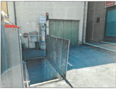
FOTO 13 - SCALA DI ACCESSO PER I TECNICI DELLA MANUTENZIONE
