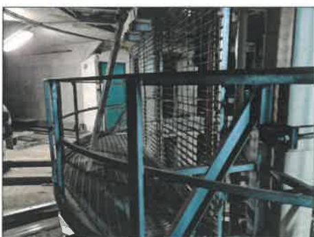
FOTO 23 - VISTA IMPIANTI, PERCORSI PEDONALI E PARAPETTI DI PROTEZIONE
