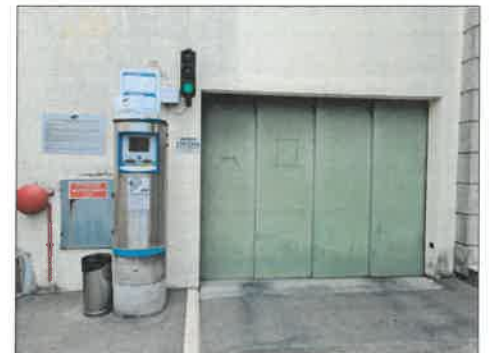
FOTO 06 - VISTA DEGLI IMPIANTI DI ACCESSO E SICUREZZA AUTOSILO
