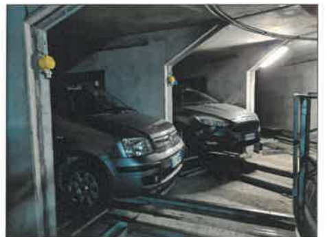
FOTO 21 - TREVİ PARK VISTA AUTOVETTURE PARCHEGGIATE
