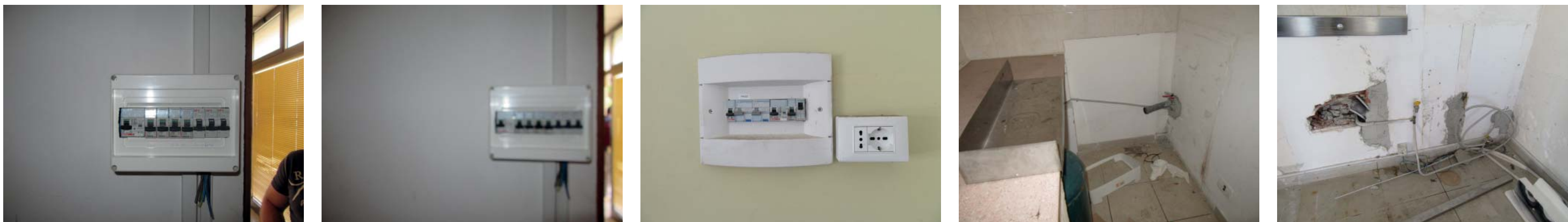
Foto da 79 a 81 , vano A1 - quadro elettrico
