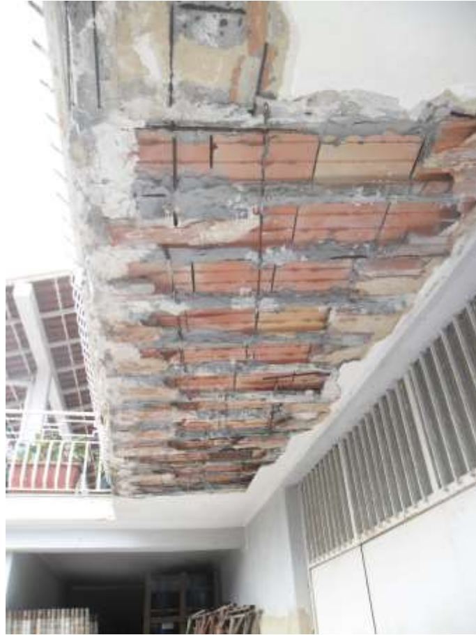
Figura 11 - Degrado ballatoio prospetto Est
