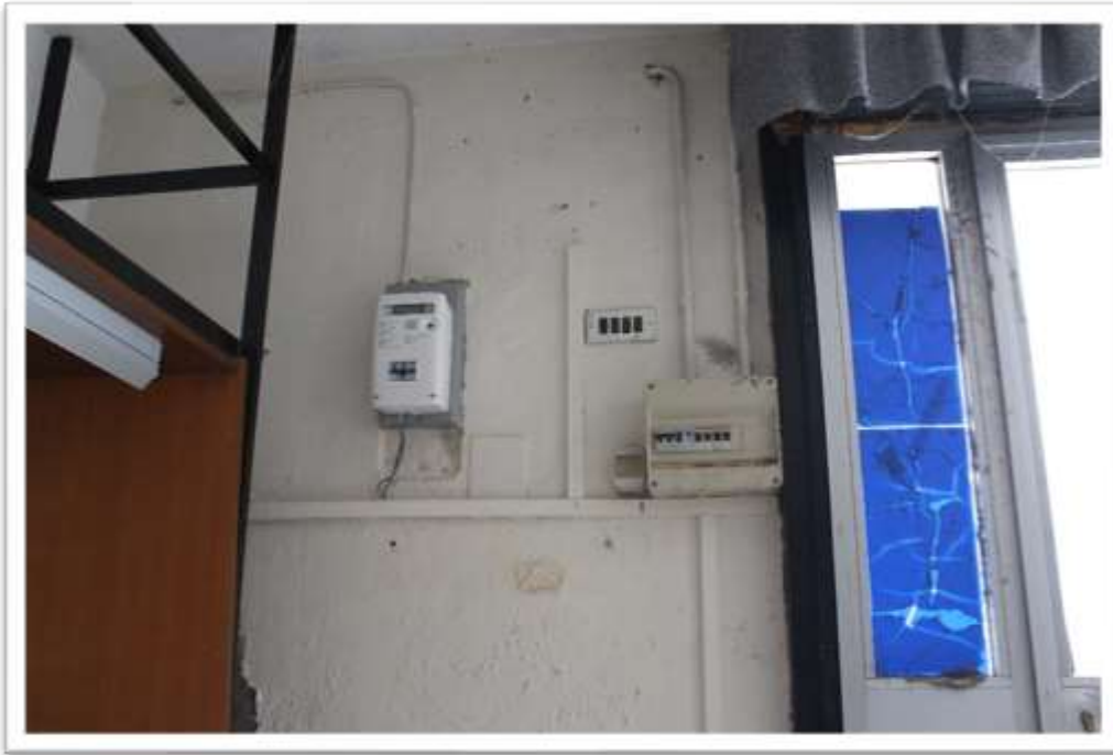
FOTO 13 – QUADRO ELETTRICO E CONTATORE ALLACCIO RETE ELETTRICA
