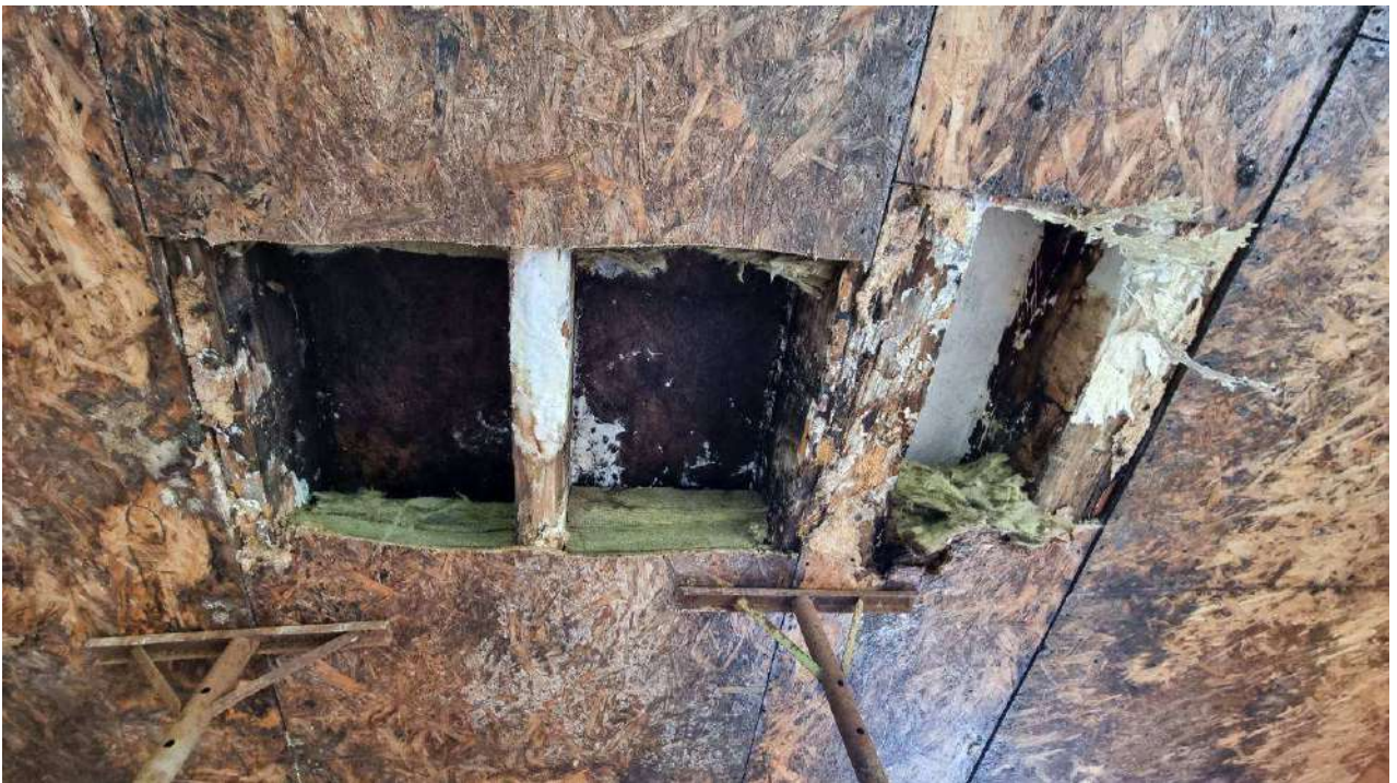
Piano terra : solaio deteriorato
