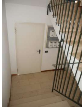
Foto 10 – locale contatori e vano scale
