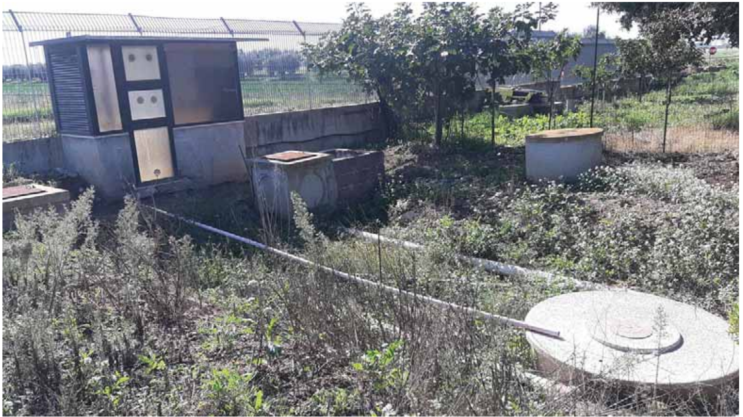
Foto terreno, Foglio 123, part. 45/59/100, impianti tecnologici
