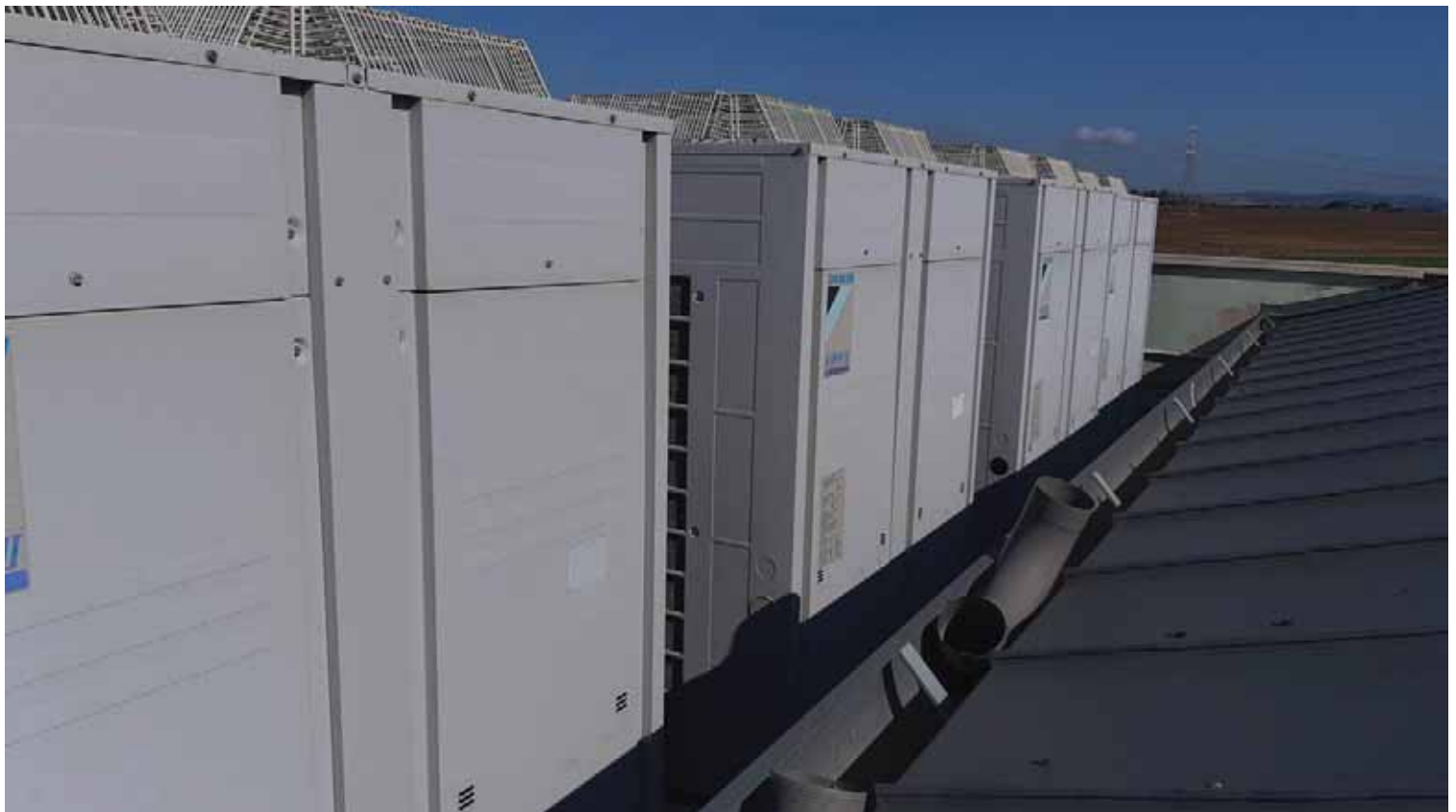
Macchinari posti su piano coperture
