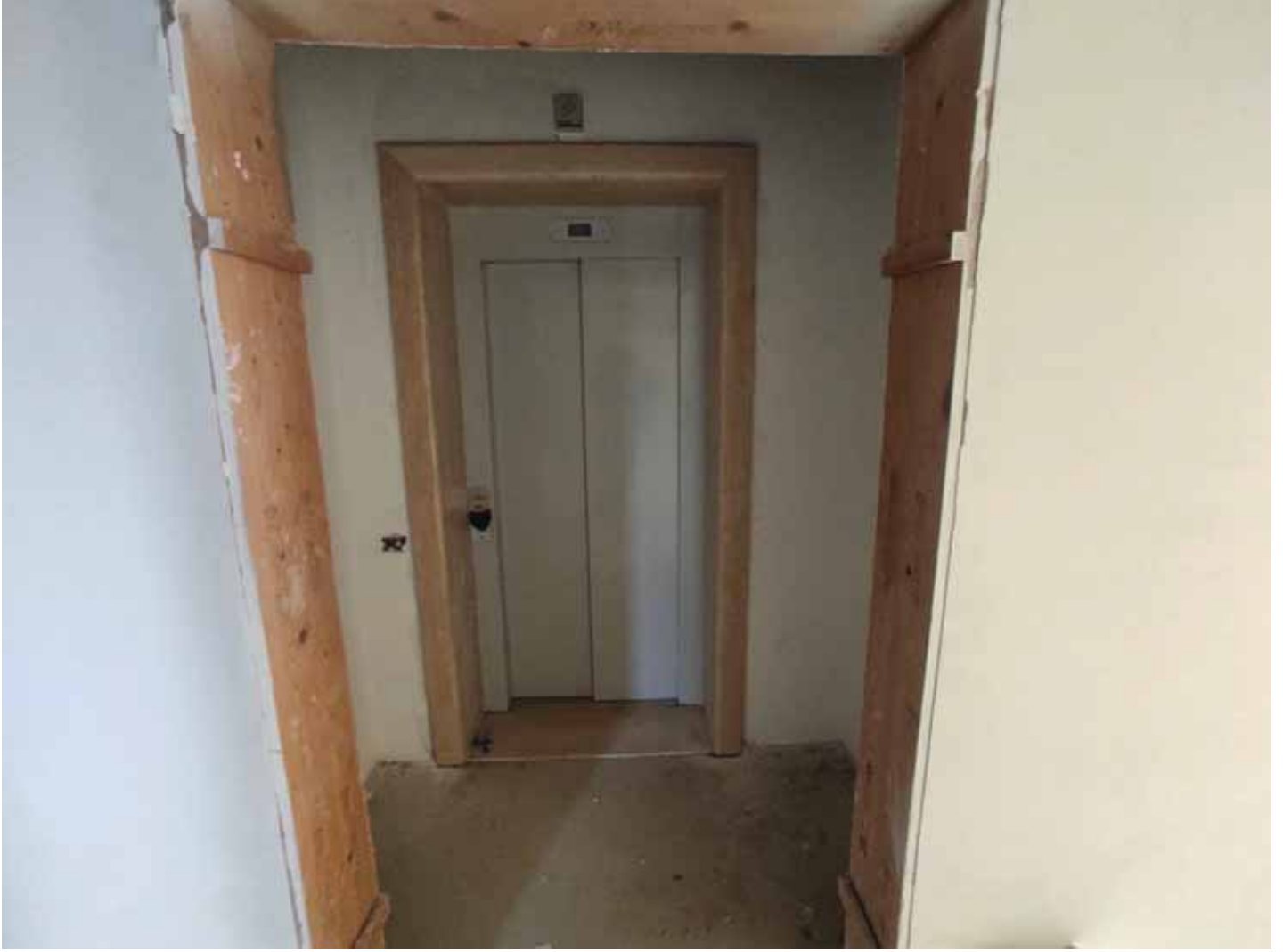
Ascensore piano terra
