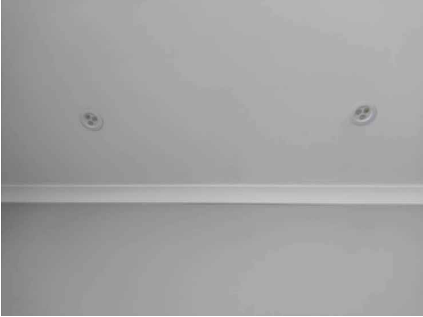
Esempio di illuminazione a soffitto
