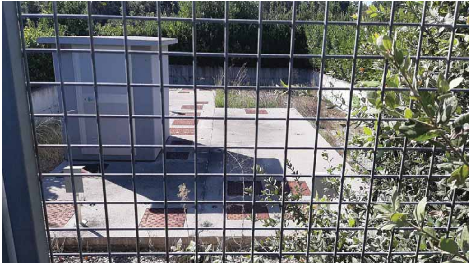
Foto terreno, Foglio 123, part. 45/59/100, impianti tecnologici.
