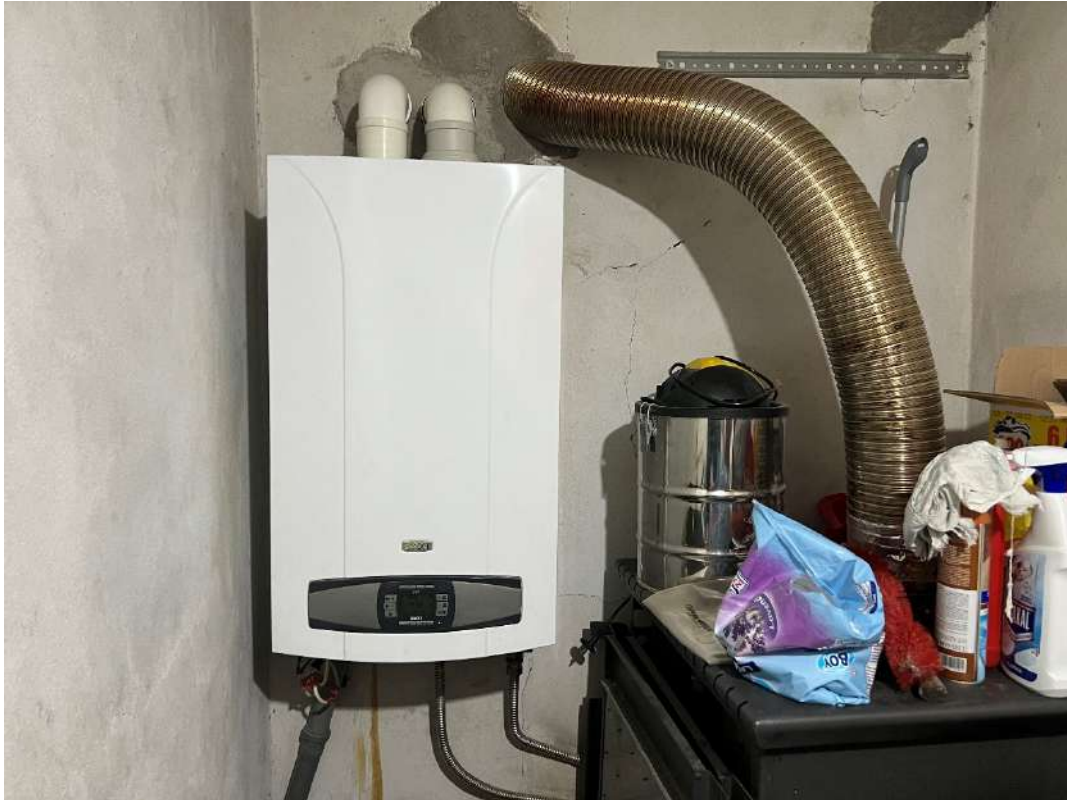
Figura 30 abitazione nm. 153 caldaia
