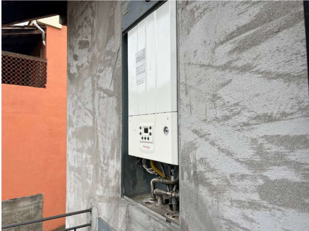
Figura 19 abitazione P1 nm. 946 caldaia
