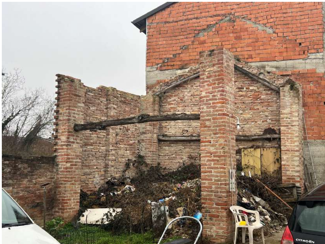
Figura 20 unità crollante posta sul sedime del nm. 946
