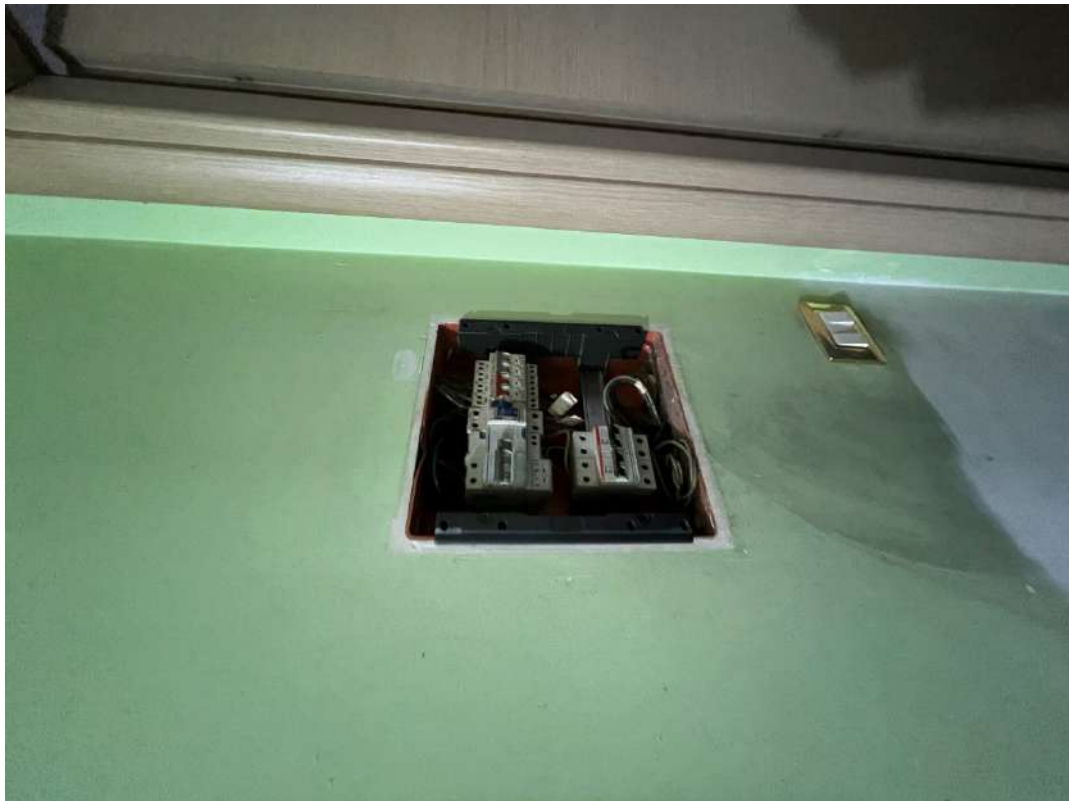
Figura 15 abitazione P1 nm. 946 particolare impianto elettrico
