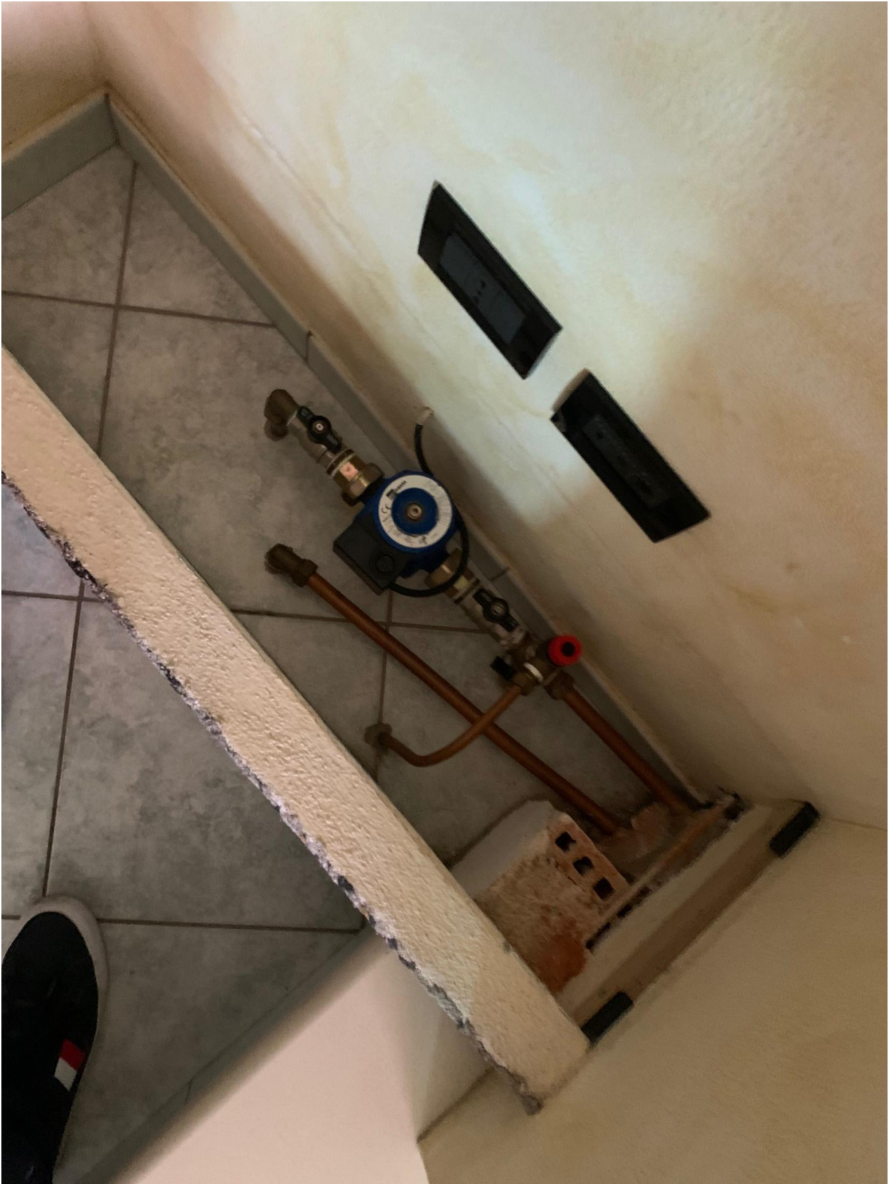
Foto_13 Centralina camino
