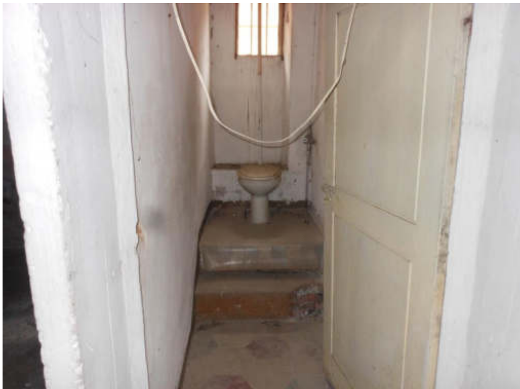
Foto 39 W.C. da regolarizzare piano terra Lotto 2
