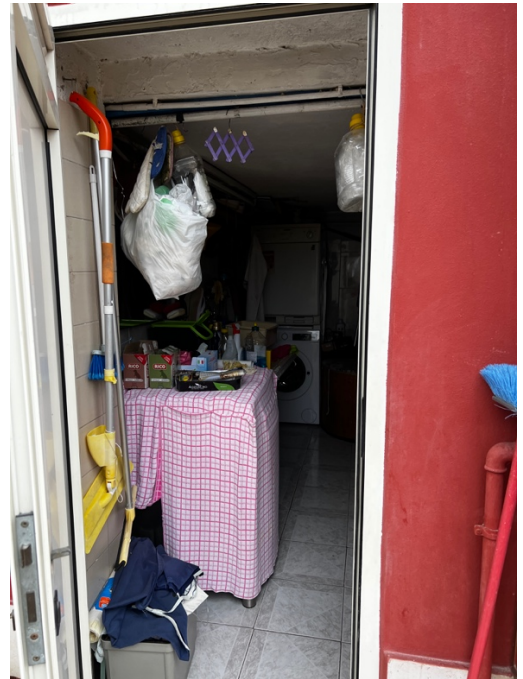
Foto n°2 - vista interna locale tecnico (Sub 3)
