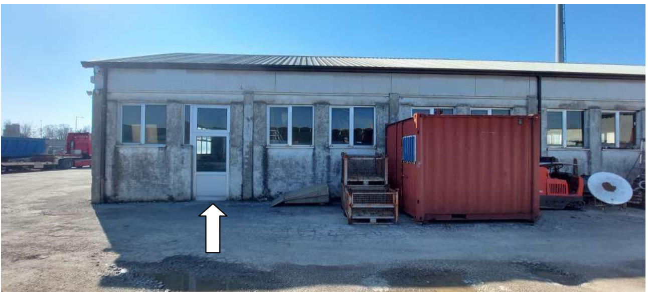
Prospetto Nord con evidenziata la porta non autorizzata
