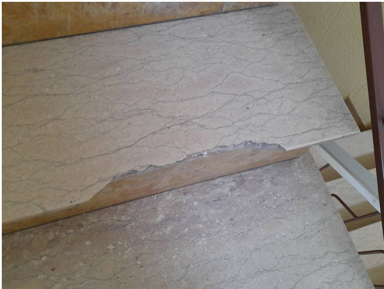
Foto 20 – vano scale condominiali Lesioni dei gradini in marmo
