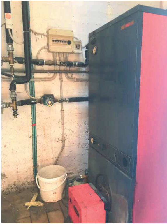
Piano interrato: centrale termica
