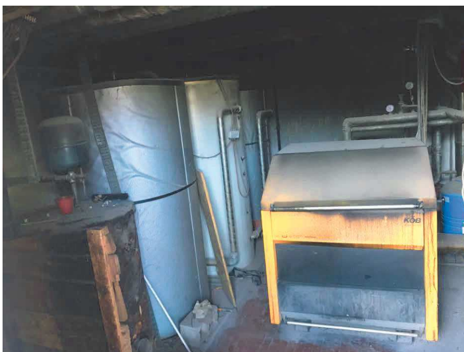
Locale centrale termica
