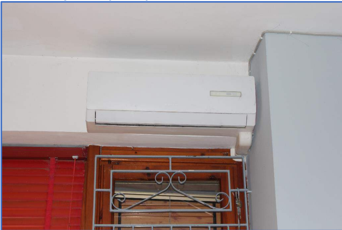
2.7 – Sub 41 – Zona giorno – Vista particolare: presenza di climatizzatore o inverter
