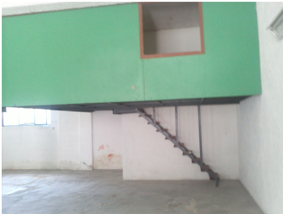
Foto 06. Struttura in ferro presente all'interno del locale identificato al catasto al foglio 37 part. 13 sub 5.
