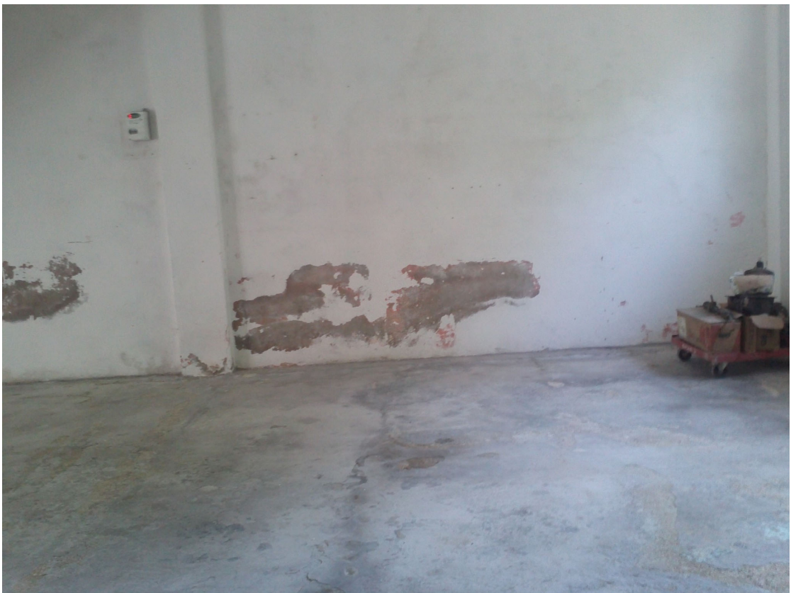
Foto 04. Umidità all'interno degli immobili.
