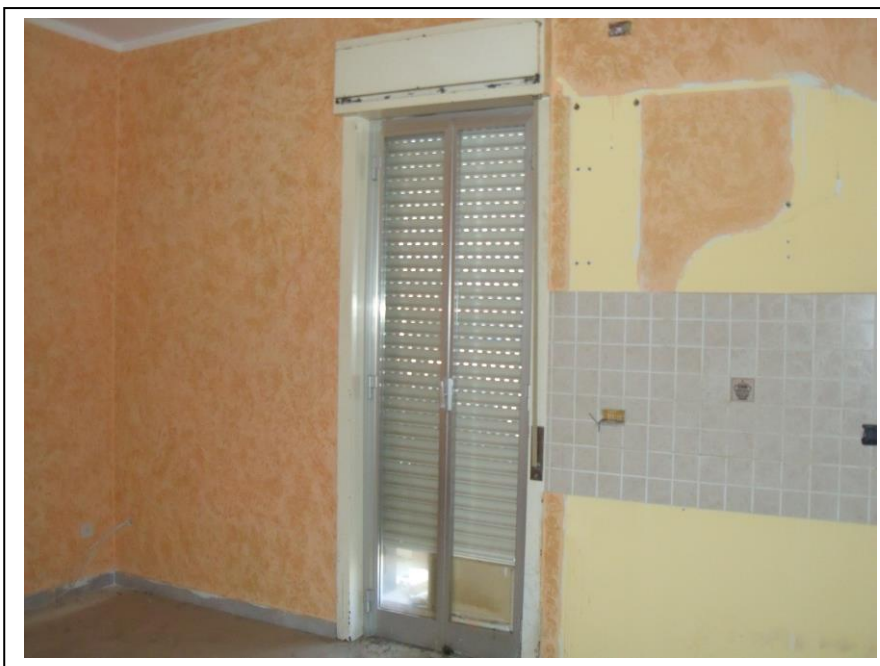
24. Interno u. i. con vista verso lato sud-ovest. Infisso vetusto, porzioni di pareti in scarse condizioni di manutenzione.
