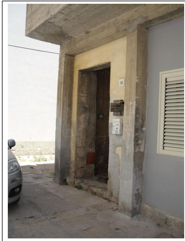
03. Vista prospettica della costruzione con prospetto laterale su stradella di accesso, piano terra. Ingresso a n. civico 10.
