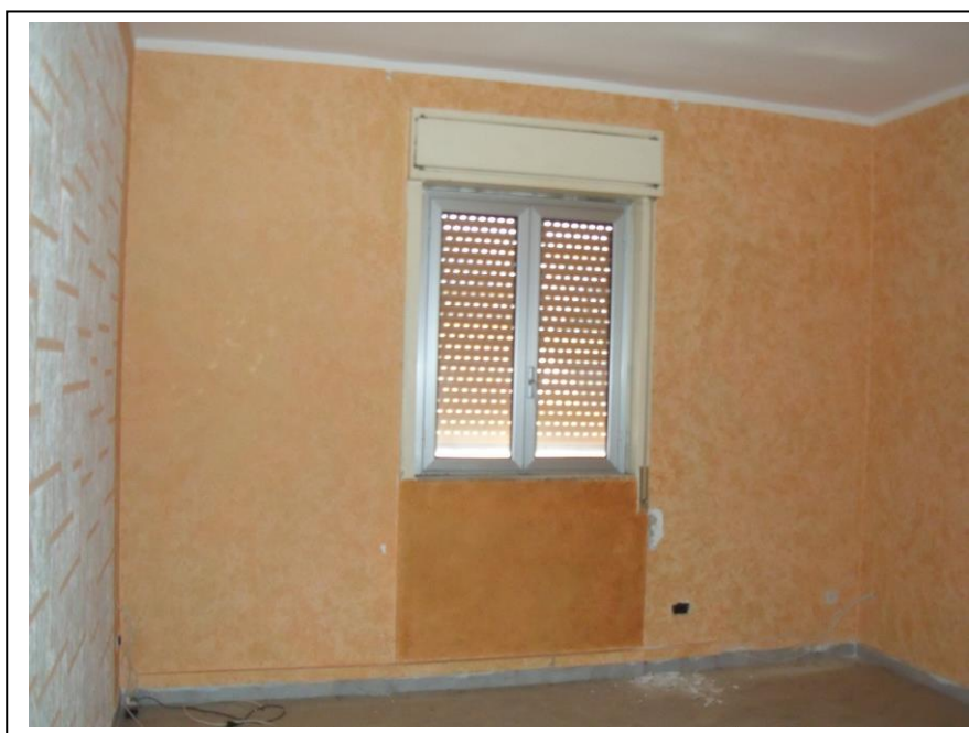
23. Interno u. i. con vista verso lato sud. Parziale distacco di intonaco in piccole porzioni di parete. Infisso vetusto.
