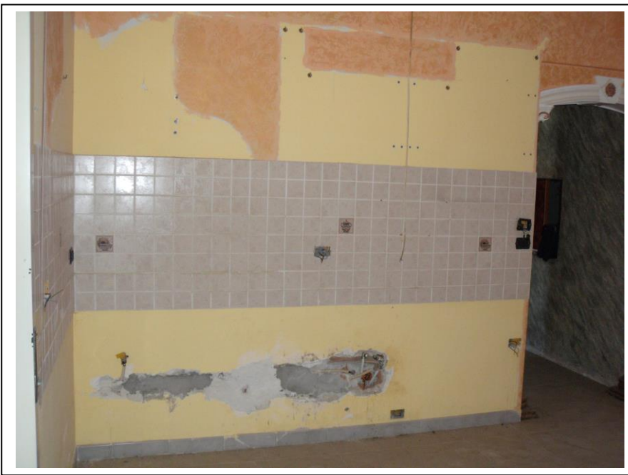
25. Interno u. i. con vista verso lato nord. Parziale distacco di intonaco in porzioni di parete in scarse condizioni di manutenzione.
