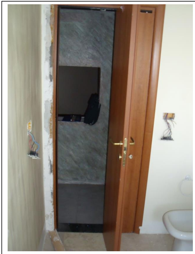
19. Interno servizio igienico con vista verso lato porta di accesso, lato sud, presenza di prese elettriche non posizionate, con fili uscenti. Mancanza di montante sinistro del telaio della porta.
