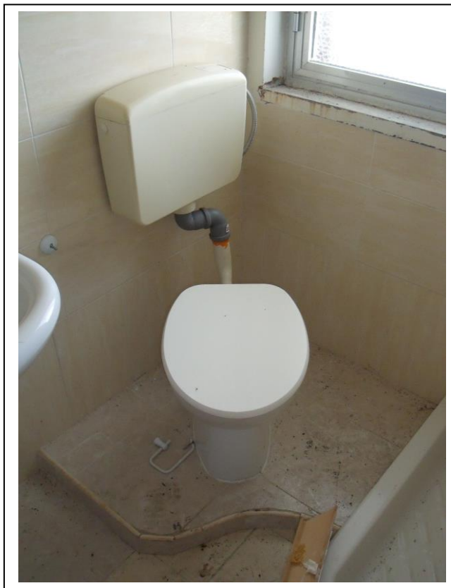
21. Interno servizio igienico con vista verso lato sud-ovest. Presenza di finestra vetusta.
