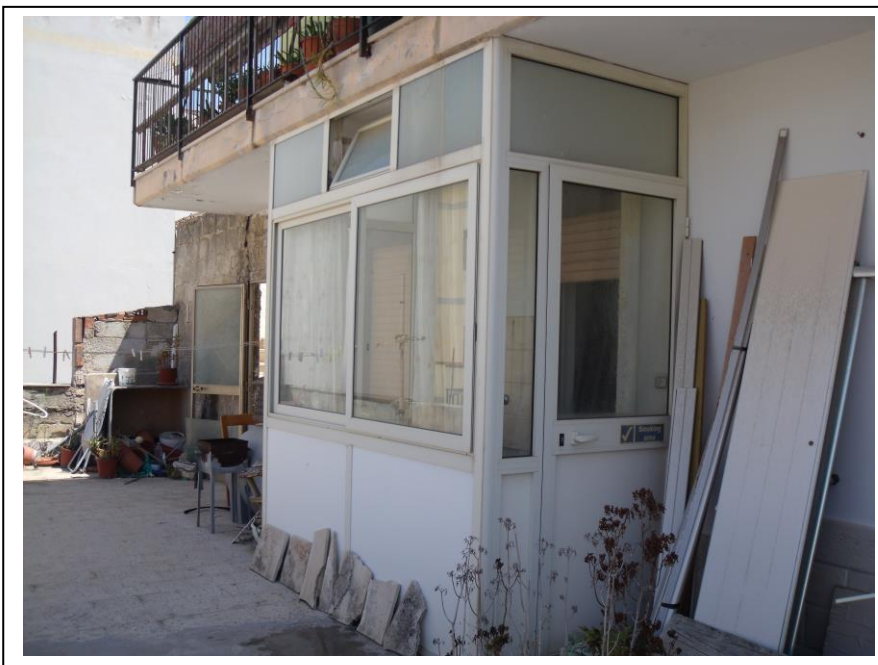
10. Terrazzo comune al piano 2, presenza di veranda abusiva di proprietà dei debitori in causa.
