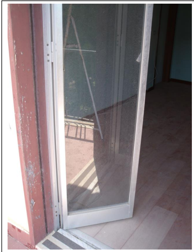
31. Esterno all'u. i. con vista verso lato nord-ovest, presenza di infisso vetusto di accesso al balcone.
