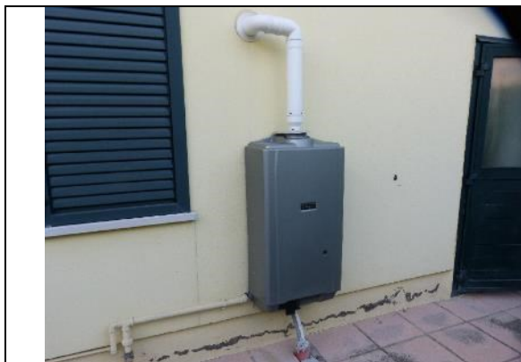
Caldaia a servizio della abitazione
