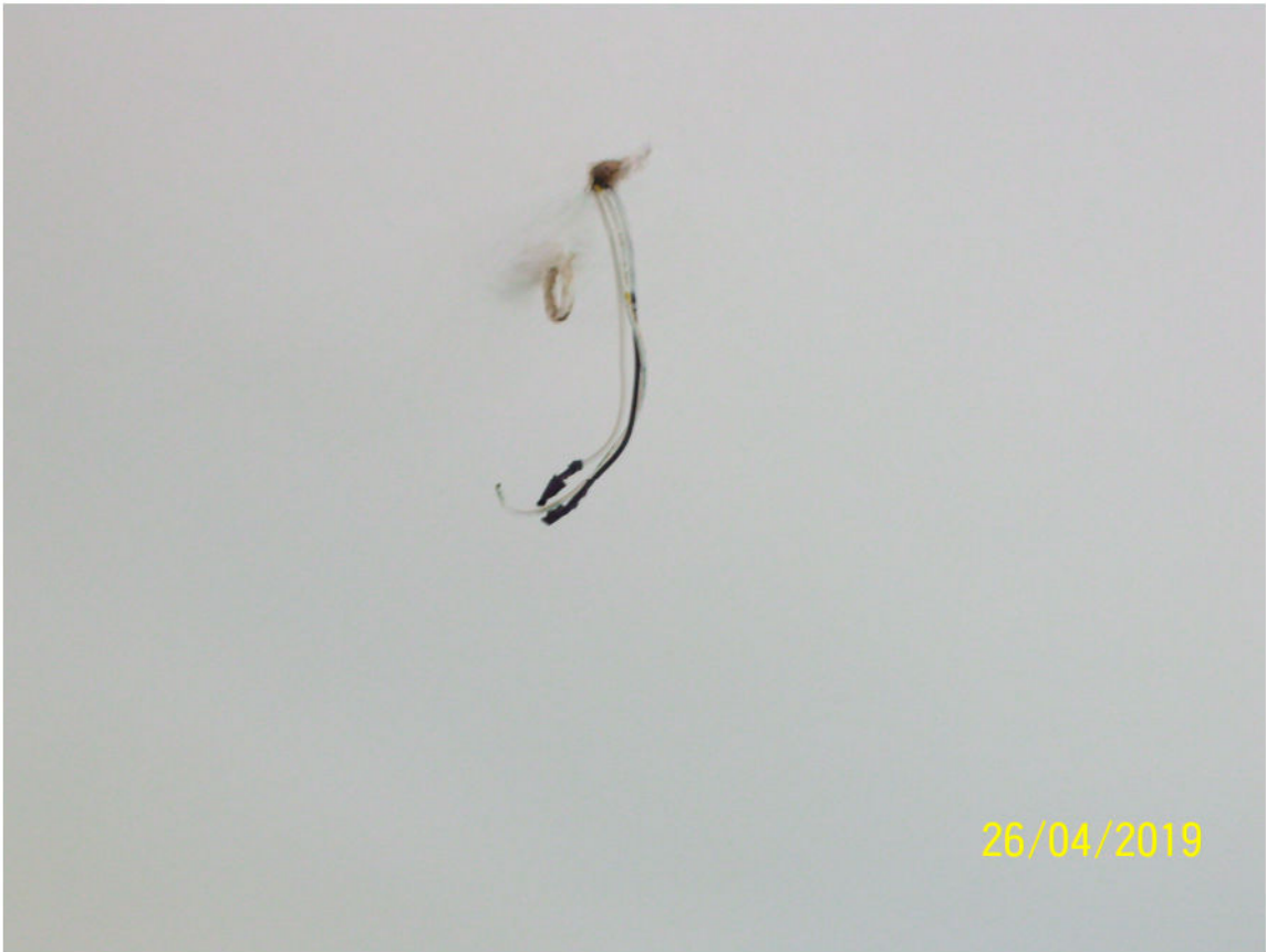
FOTO N. 47 SOFFITTO CAMERA SENZA APPLIQUE
