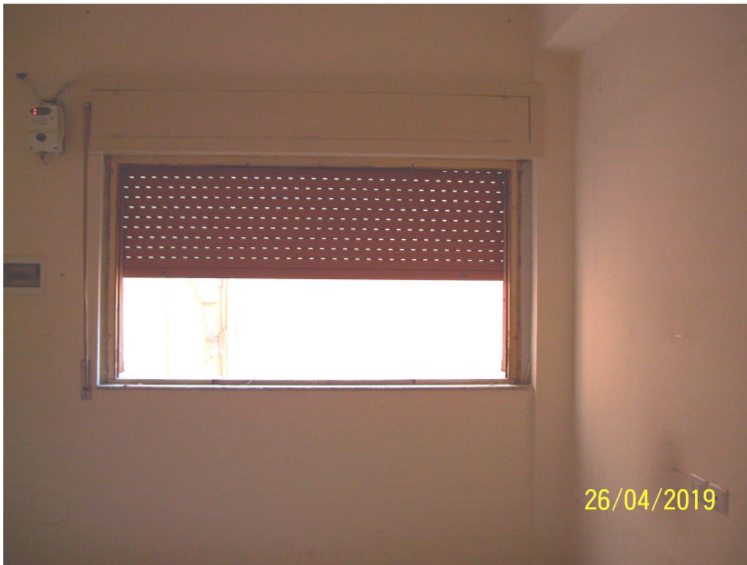
FOTO N. 6 FINESTRA SOLO CON AVVOLGIBILE MANCA INFISSO
