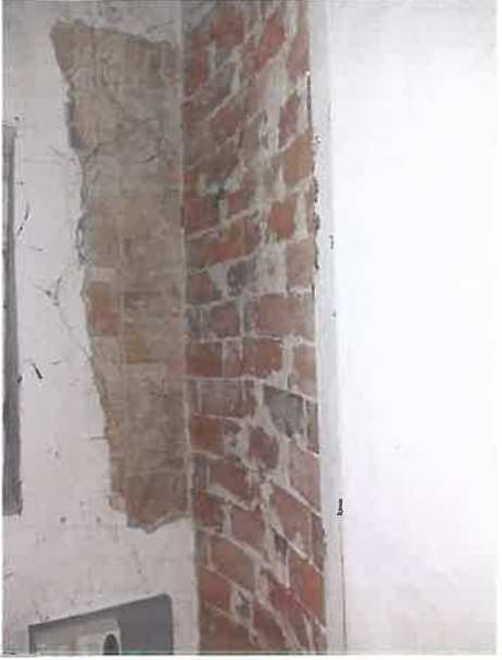
SOLAI0 PLAFON0 STANZA ADIACENTE INGRESSO
