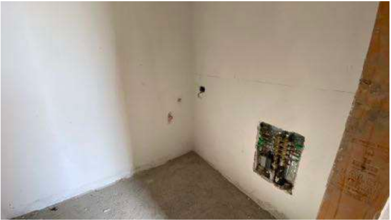
Villino bifamiliare sub 296 _ Collettori riscaldamento
