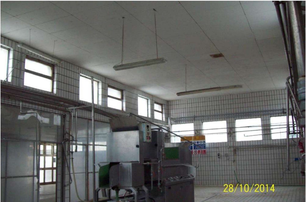
Vista interna del caseificio con gli impianti, privato delle apparecchiature e macchine . Lotto n.3
