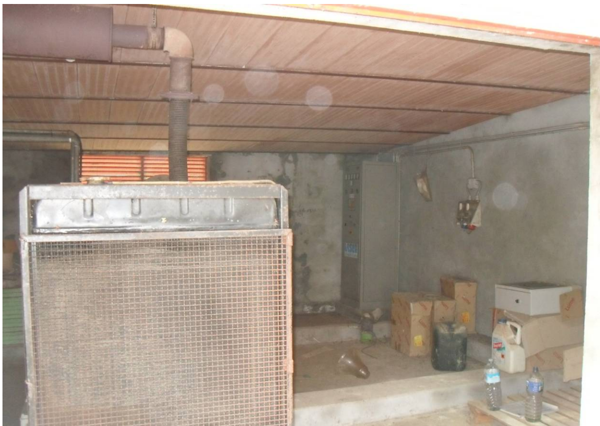
54 – LOCALE GRUPPO ELETTOGENO - Interno – (Particella 150)
