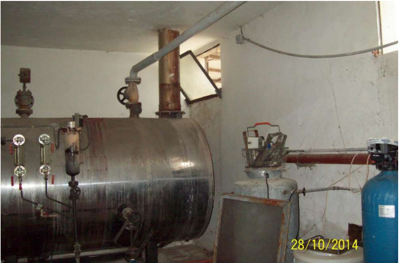
Vista impianti del caseificio Lotto n.3
