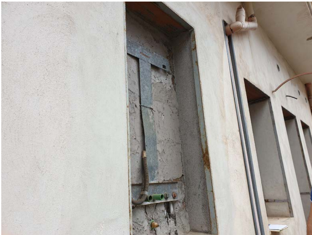
FOTO N. 29 – PREDISPOSIZIONE PER CALDAIA NEL BALCONE
