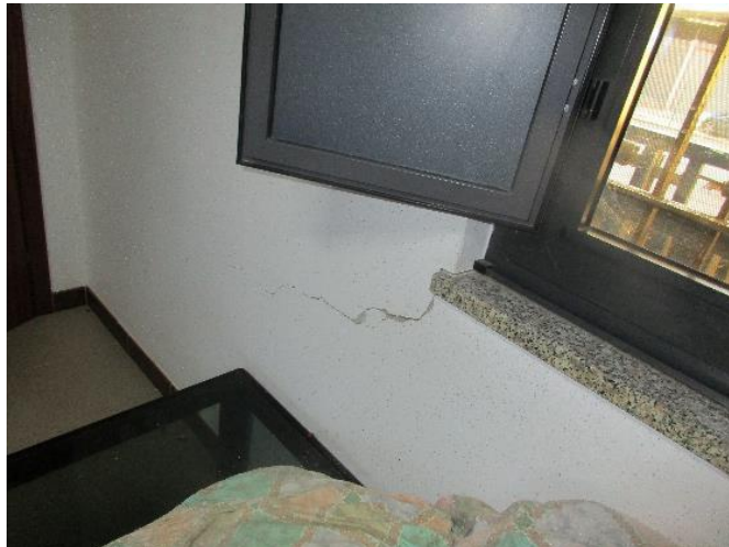
Foto n.7 – Locale ufficio – Parte bassa parete ovest – Lato interno
