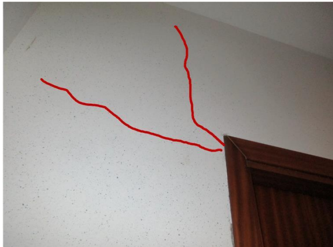
Foto n.10 – Disimpegno – Parte alta parete est – Lato interno
