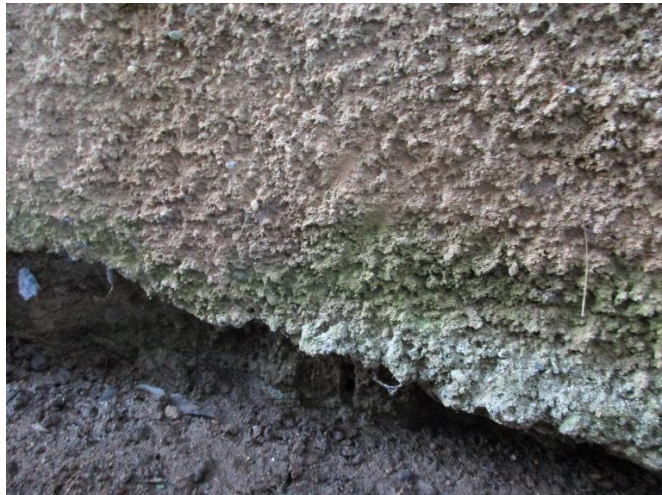
Foto n.16 – Locale Ufficio – Cedimento terreno lato est
