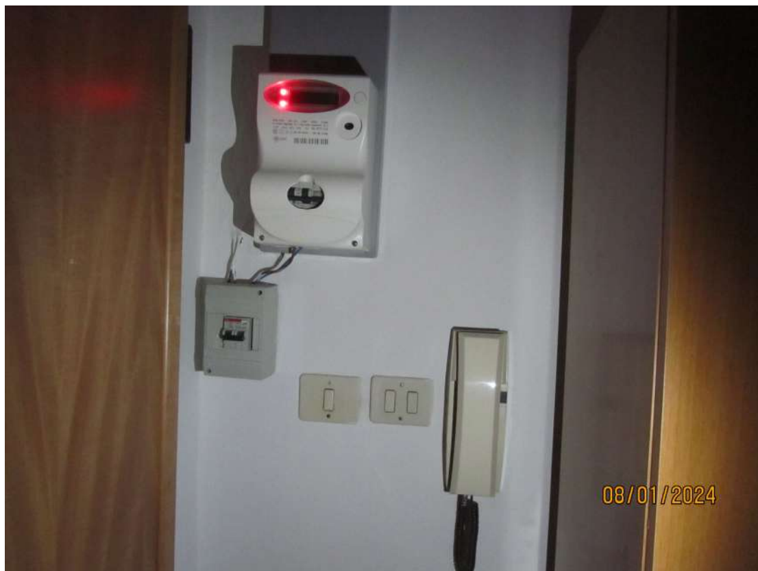
FOTO N.16 - Particolare interruttori elettrici e citofono.
