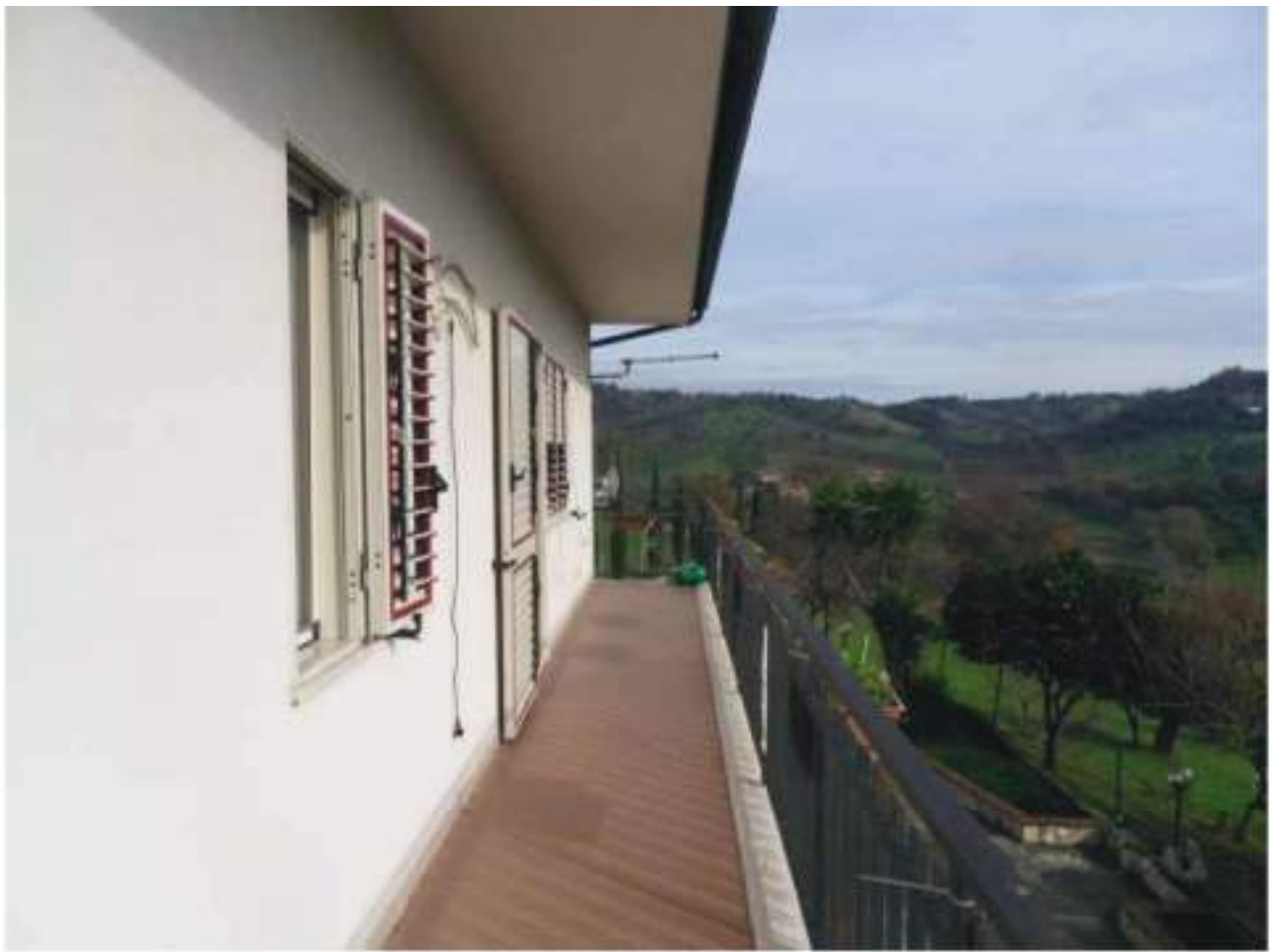
FOTO N. 79: Esterni Bene N. 1 (PIANO PRIMO - Balcone)
