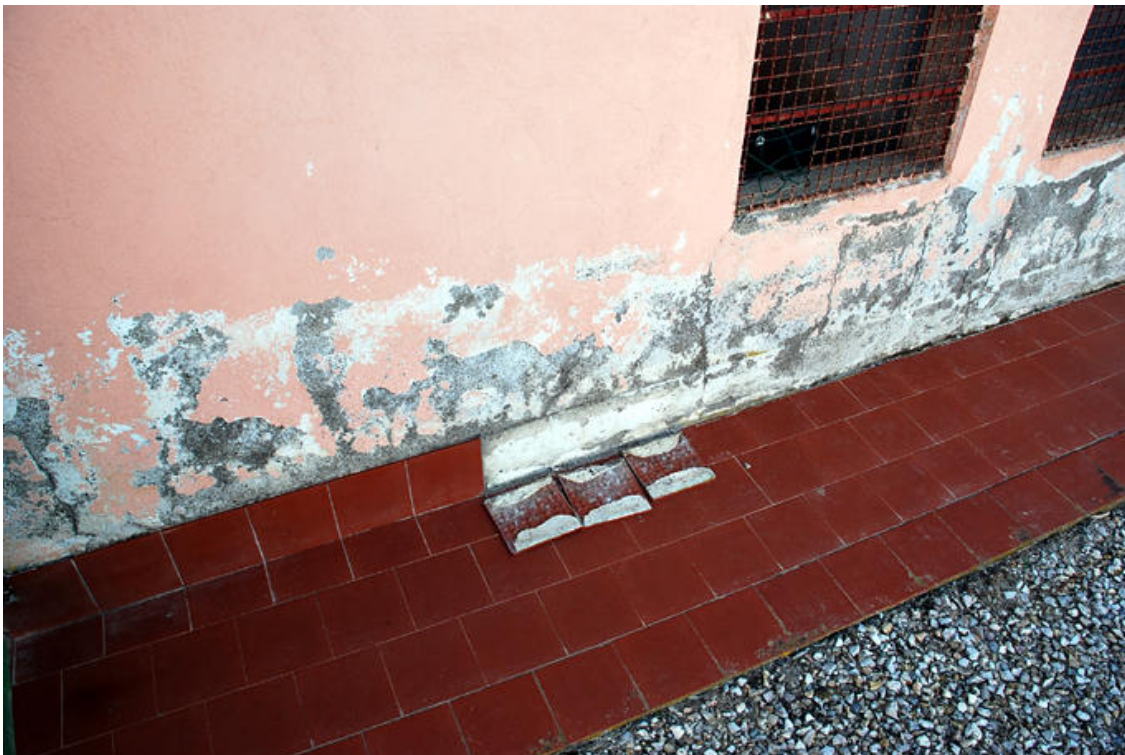
Rif.fot.37 - Umidità di risalita su muratura esterna magazzino
