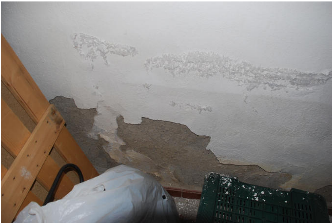
Rif.fot.45- Particolare umidità di risalita piano terra fabbricato principale
