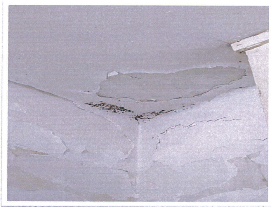
Infiltrazioni di acqua soffitto bagno
