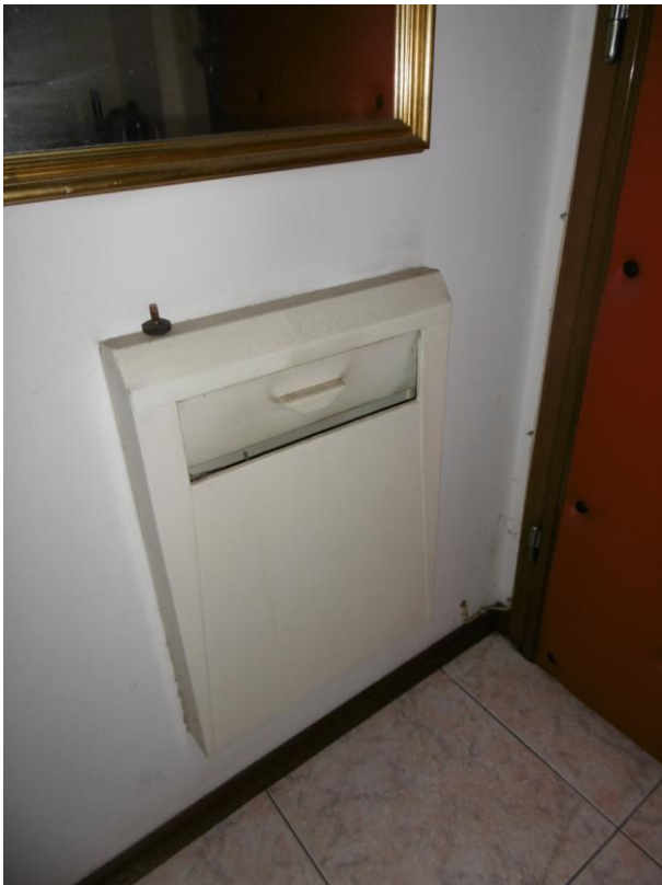
Interno – Alloggio – Radiatore
