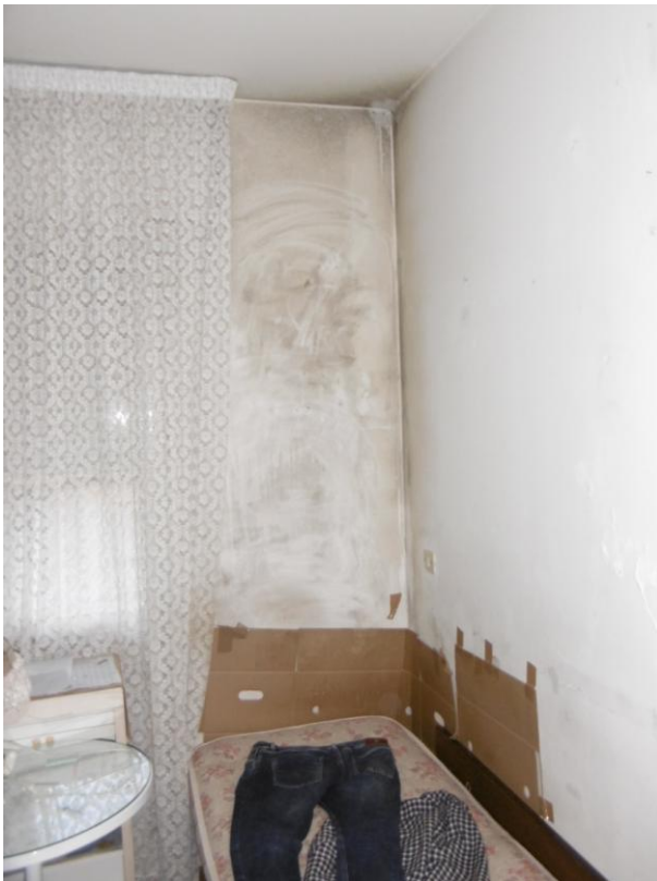
Interno – Alloggio - Precarietà
