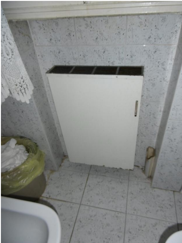
Interno – Alloggio - Radiatore
