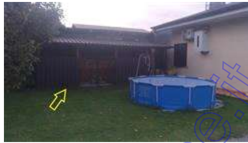
Tettoia non autorizzata: vista di fronte
