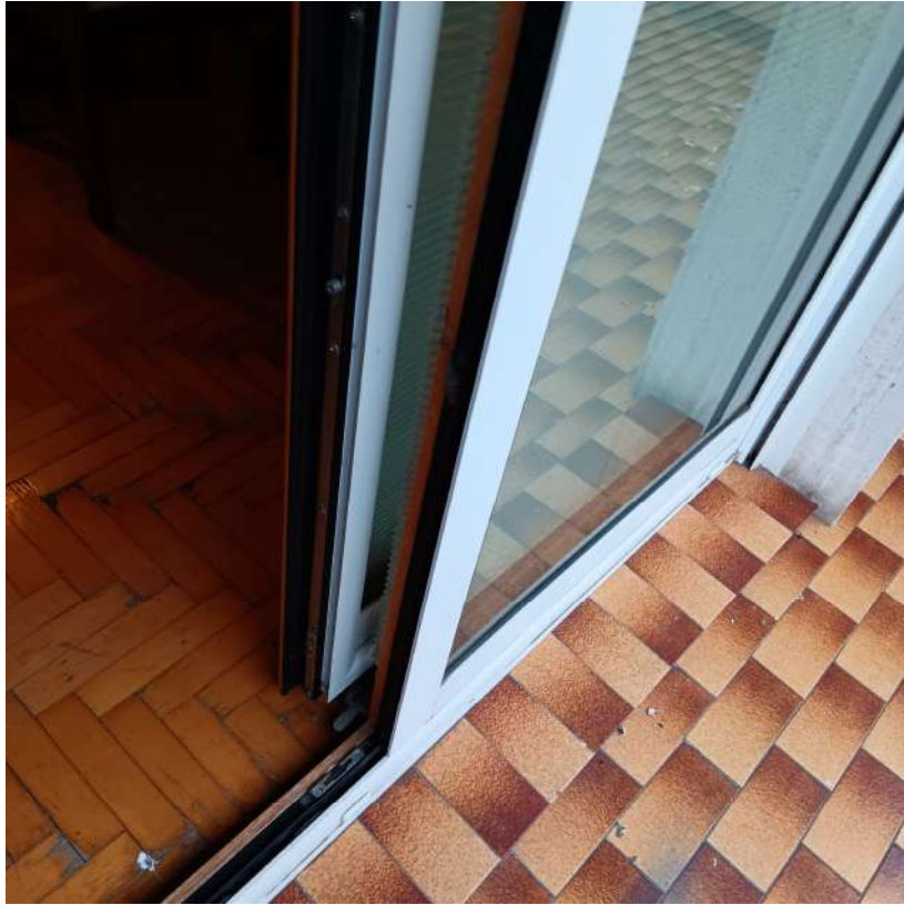
FOTO N. 15 - POGGIOLO - PARTICOLARE SERRAMENTO
