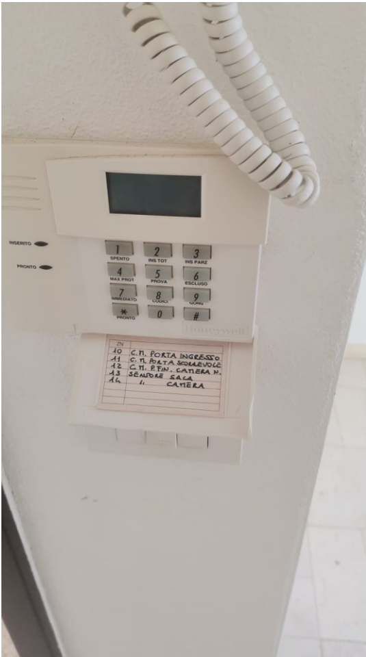
FIGURE 18: A) IMPIANTO CITOFONICO;
