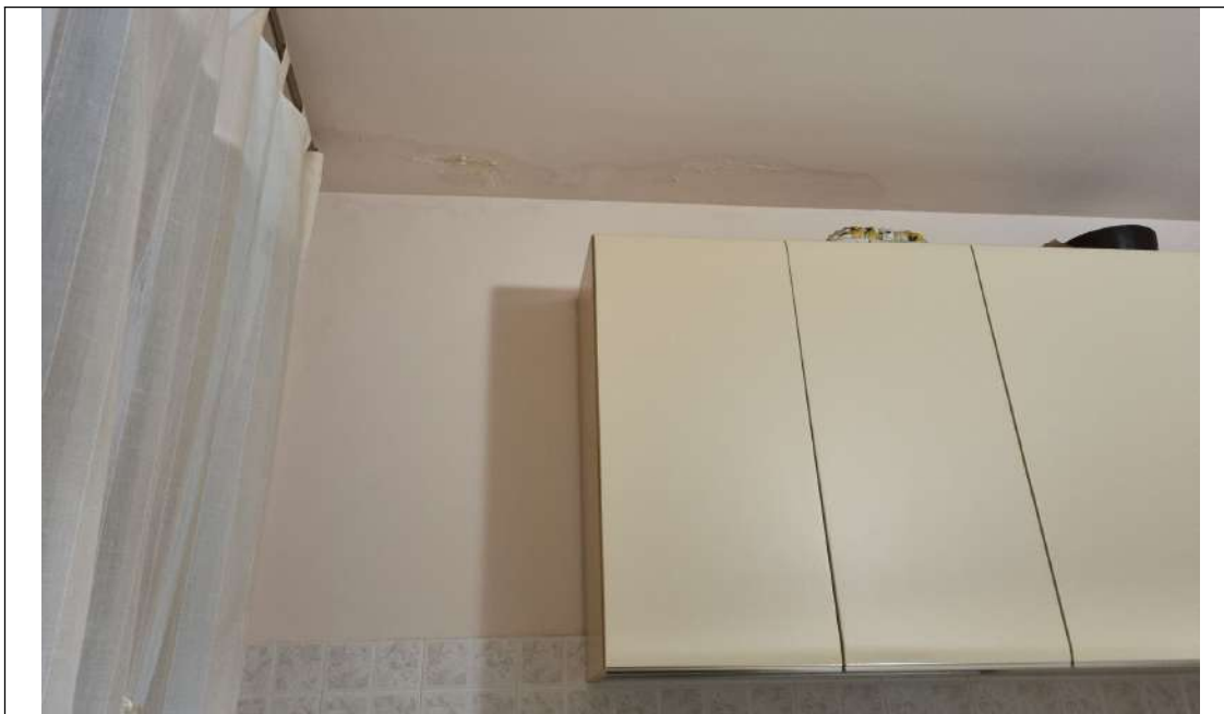
2. Piano Terra (cucina): presenza di muffa.
